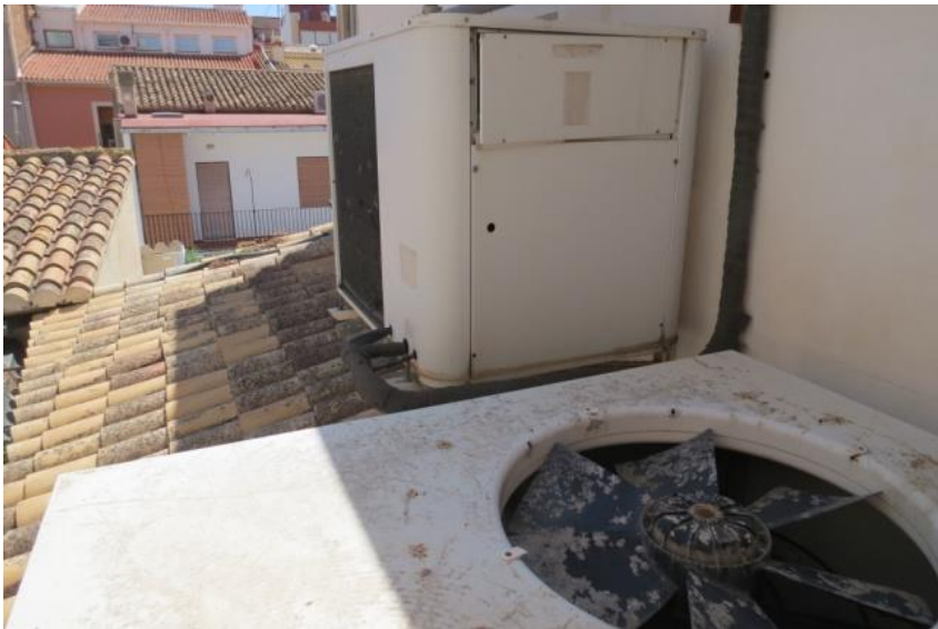
Figura III.31. Área privada. Zona de instalaciones en cubierta. Fuente: autor
