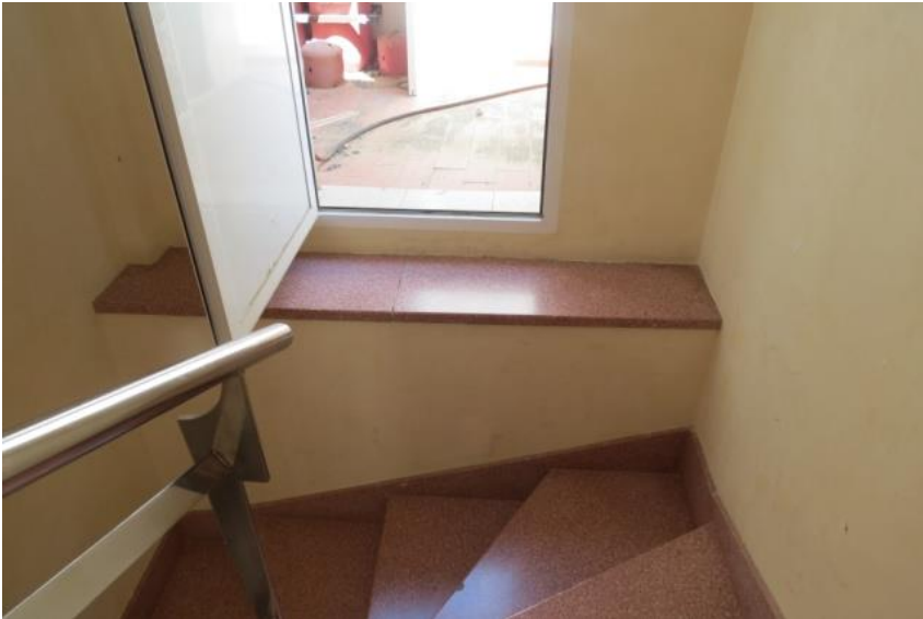
Figura III.30. Área privada. Acceso a dependencia de instalaciones en cubierta. Fuente: autor
