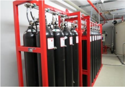
Figura III.149. Dependencias de instalaciones. Fuente: autor
