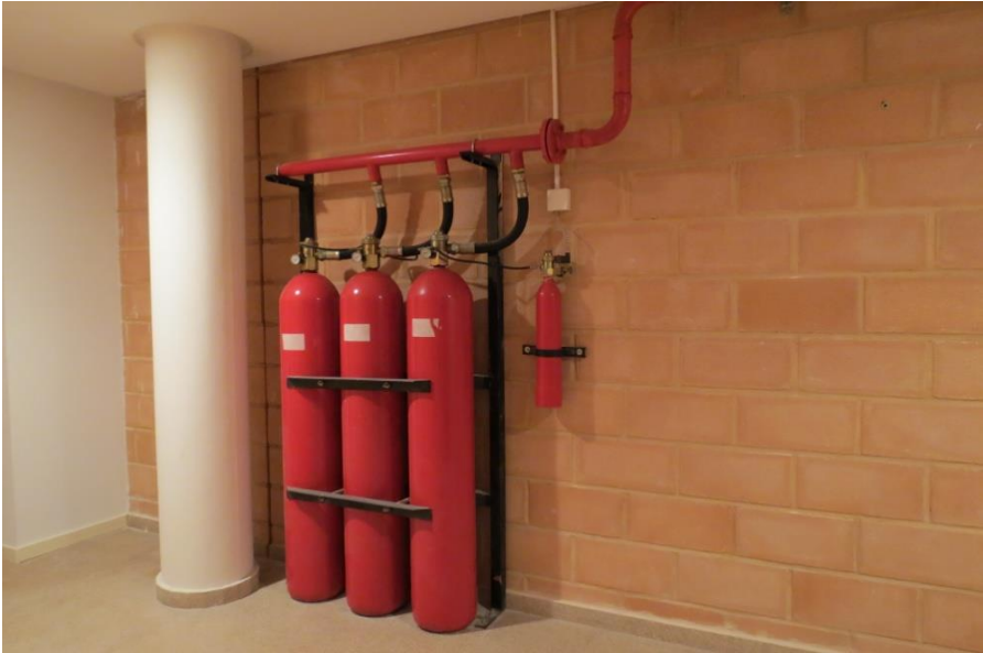
Figura III.201. Instalaciones. Sistema de extinción de incendio mediante gas. Fuente: autor
