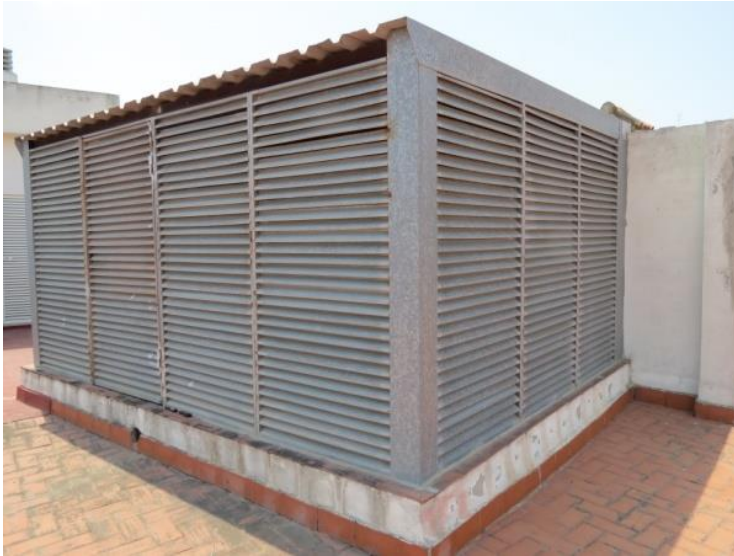
Figura III.118. Cuarto de máquinas en cubierta. Fuente: autor
