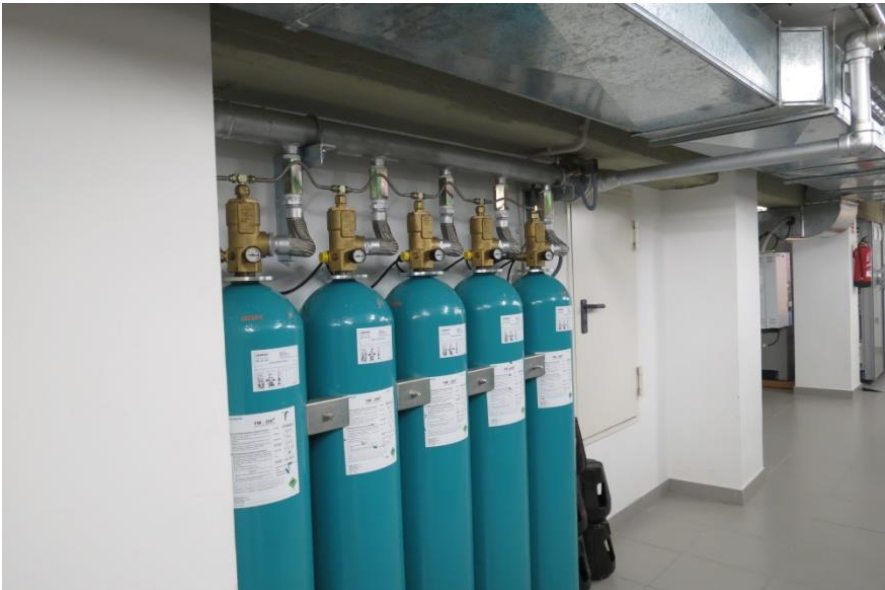
Figura III.178. Instalaciones. Sistema de extinción de incendio mediante gas FM-200. Fuente: autor
