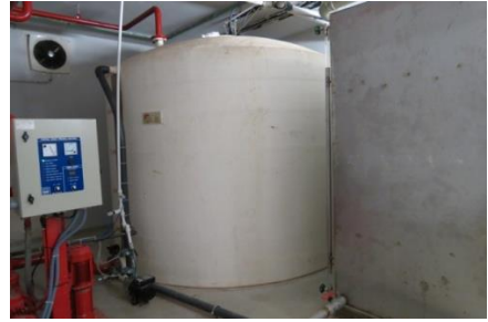
Figura III.150. Depósitos de agua para extinción de incendio. Fuente: autor
