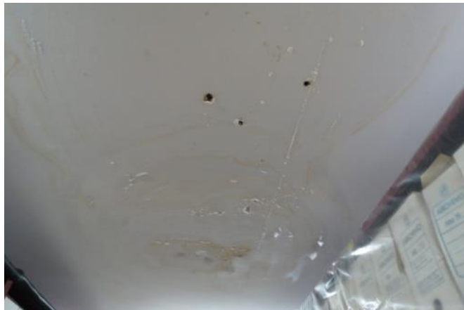
Figura III.198. Daños producidos en el techo de depósito por la filtración de agua de la cubierta. Fuente: autor
