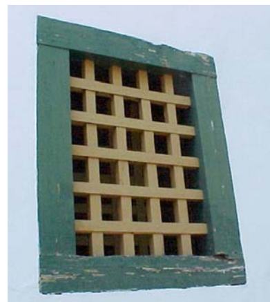
Fig. 151 - Ventana de la celda menor del Ayuntamiento y Cárcel de la Ciudad de Goiás, Goiás. (Foto de la autora).
