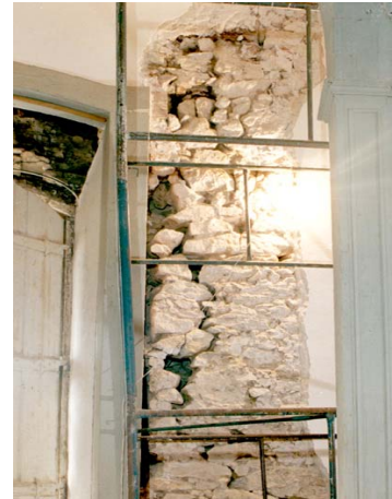
Fig. 227 – Pared de piedra de la Iglesia Nuestra Sra. de la Buena Muerte – Ciudad de Goiás, Goiás. (Foto del acervo de la Constructora Biapó – Goiânia, Goiás).
