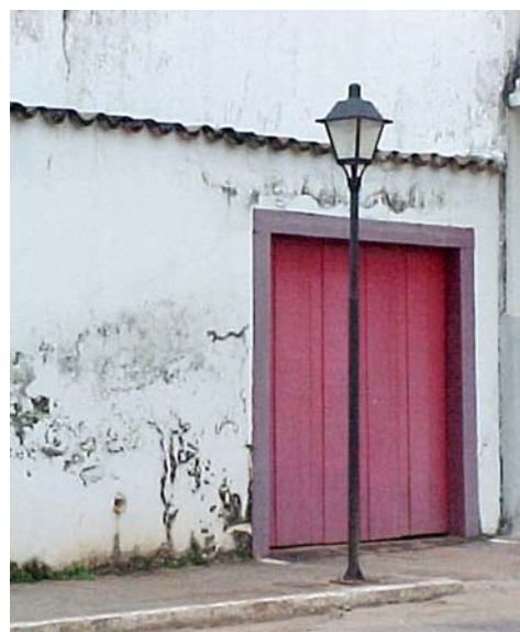
Fig. 341 – Acceso al garaje de la Casa del Obispo - Ciudad de Goiás, Goiás. (Foto de la autora).
