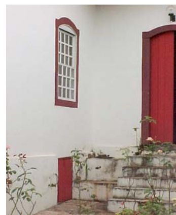
Fig. 339 – Sótano de la Casa del Obispo – Ciudad de Goiás, Goiás. (Foto de la autora).
