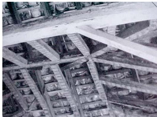
Fig. 353 – Estructura de la cubierta de la Casa del Obispo 1985 - Ciudad de Goiás, Goiás. (Foto del acervo de la Oficina Técnica de IPHAN de la Ciudad de Goiás – Goiás).
