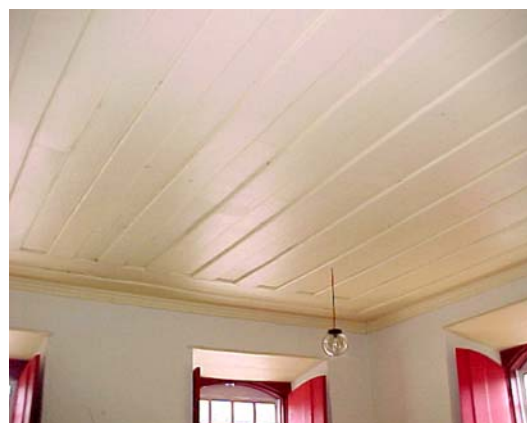
Fig. 380 – Falso techo de la Casa del Obispo - Ciudad de Goiás, Goiás. (Foto de la autora).
