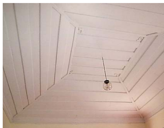
Fig. 378 – Falso techo de la Casa del Obispo - Ciudad de Goiás, Goiás. (Foto de la autora).
