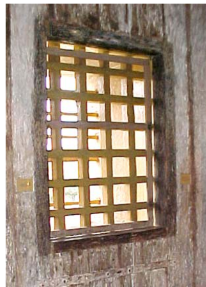
Fig. 149 - Reja interna de la ventana de la celda mayor del Ayuntamiento y Cárcel de la Ciudad de Goiás, Goiás. (Foto de la autora).
