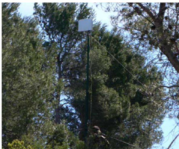
Figura 118. Estación Base WiMAX
