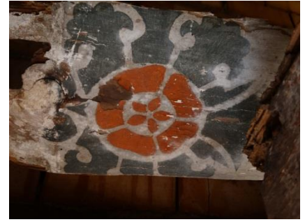
107 SAA. Perdida de policromía y manchas de humedad.
