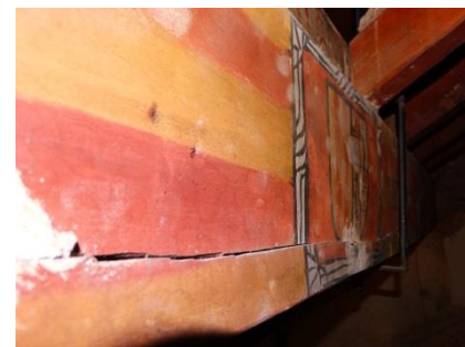
104 SAA. Rotura longitudinal de correa.
