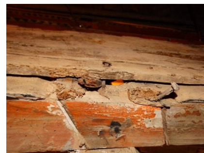
106 SAA. Pérdida de tablero sobre cabio y efectos humedad.
