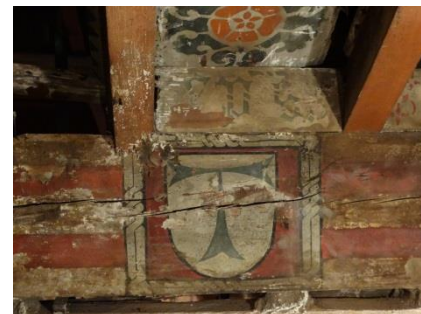
109 SAA. Deterioros en madera y policromía por la humedad.
