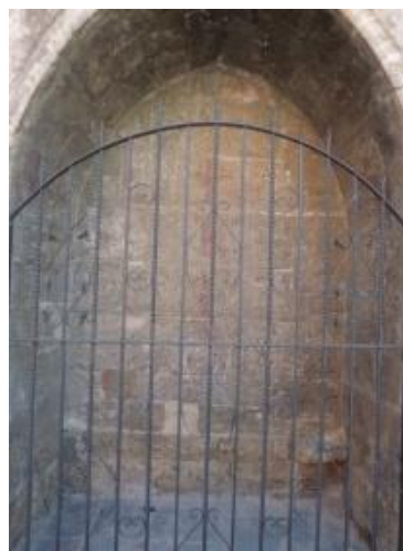
Fig. 32. Suciedad provocada por la contaminación de tráfico rodado. Arcosolios funerarios de la Iglesia de los Santos Juanes, Valencia, España.
