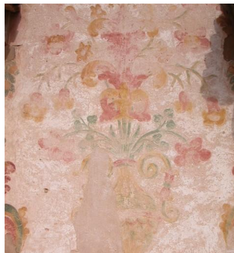
Fig. 30 Detalle la erosión provocada sobre la superficie pictórica por varios agentes patógenos. Fachada Galería Dorada Palau Ducal, Gandía, Valencia, España.
