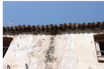
Fig. 29. Daños producidos en una fachada policromada por el mal estado del sistema de evacuación de agua pluvial. Albaida, España.
