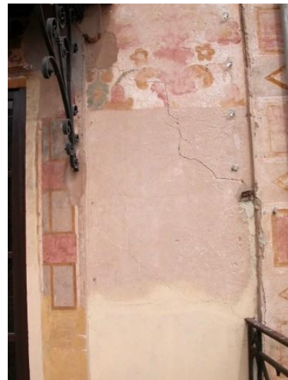
Fig. 33. Detalle de morteros de reposición sobre fachada policromada. Palau ducal, Gandía .
