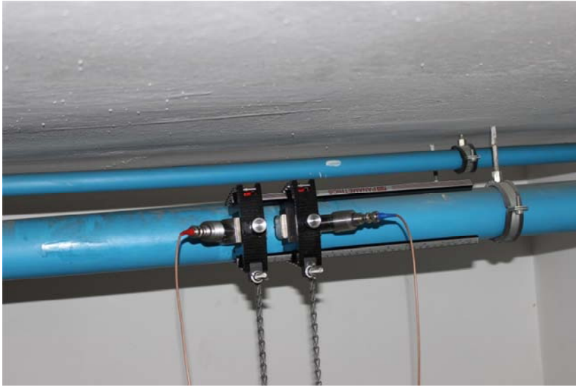
Figura 2.11. Equipo de medida para el conjunto de un edificio
