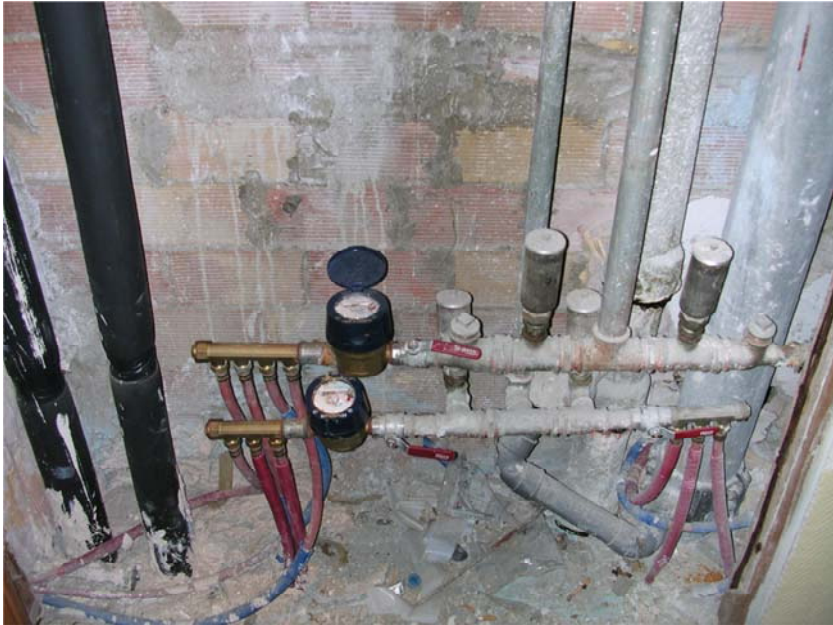
Figura 2.10. Contadores instalados en la alimentación de un núcleo húmedo
