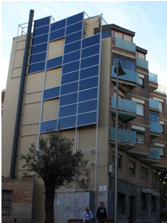
Fig. 37 "Migdia de la Trinitat": se ha decidido por instalar paneles fotovoltaicos para aprovechar la energía solar que incide sobre la medianera.
