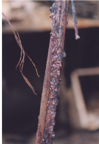
Figura 2.26 Conductor neutro afectado por una sobreintensidad en un incendio (imagen propia)
