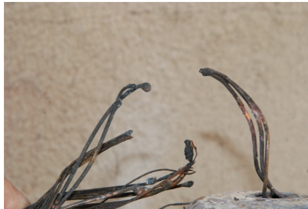
Figura 3.9 Muestra de cableado de cobre procedente del incendio denominado CASO 3 (imagen propia)
