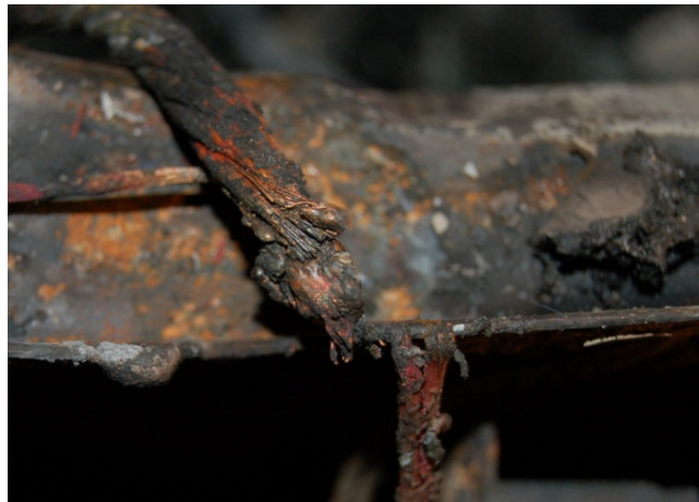
Figura 2.24 Cableado y arista cortante seccionados en un punto de derivación en una máquina calcinada (imagen propia)
