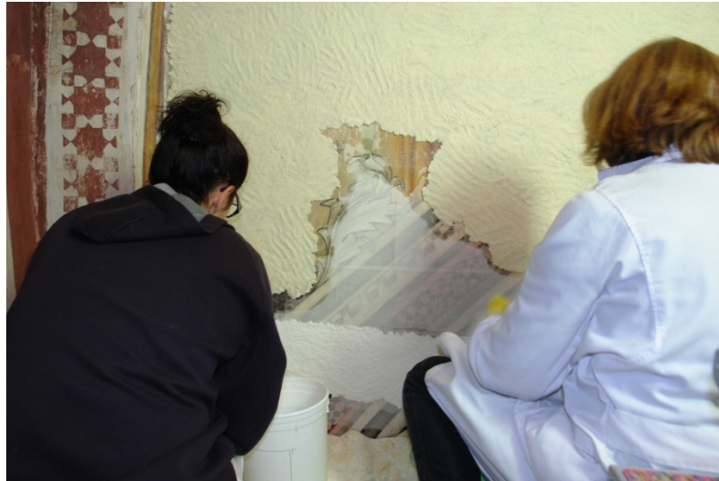
Fig.42 Aplicación de la pasta del impacco de arriba y abajo. En la imagen se ve claramente la zona mojada por la solución que se debe cubrir inmediatamente con la siguiente dosis de pasta a aplicar.
