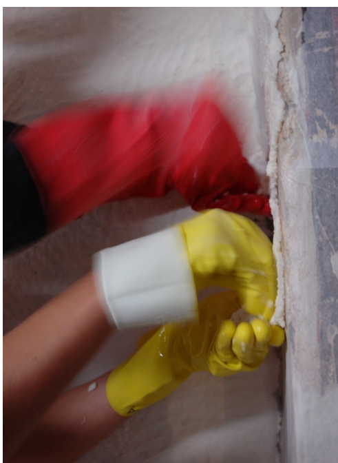
Fig.40 Imagen de la aplicación de la pasta en sentido contrario al usual. En una mano se tiene una cantidad de pasta concreta y en movimiento descendiente y continuo, con la otra mano, se va aplicando con el anverso de los dedos la capa de pasta necesaria sobre la superficie pictórica, poniendo suma atención a no dejar bolsas de aire entre la pasta y la superficie
