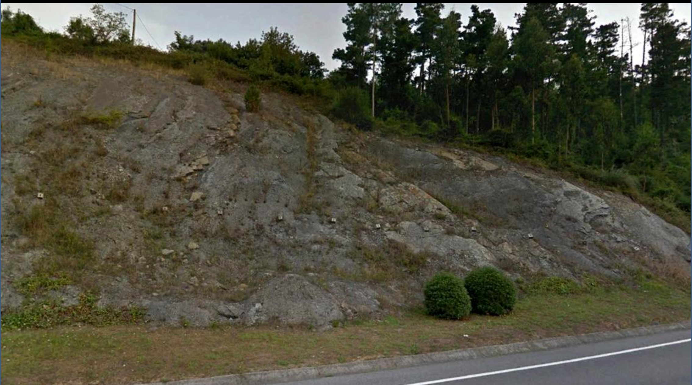
Bulonado en las calizas y margas del Santoniense Sup.-Maestrichtiense, Cretácico Sup. S de Meakaur de Munguía. NW Hoja de Durango.
