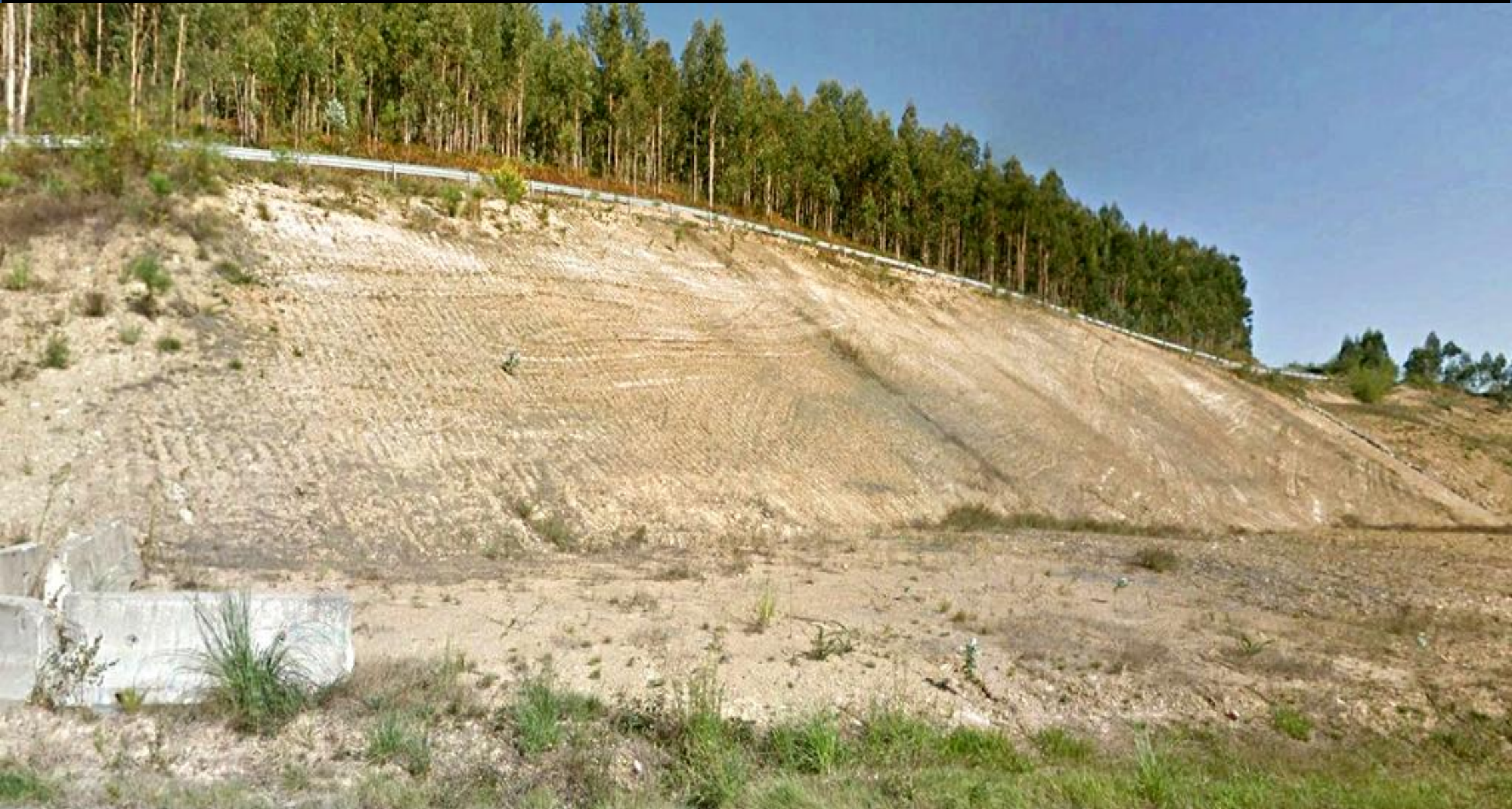
Talud metaestable en las argiollitas y cuarzoarenitas falladas, del Albiense, Cretácico Inf., al NW de San Lorenzo de Maruri, Vizcaya. SE Hoja de Algorta.
