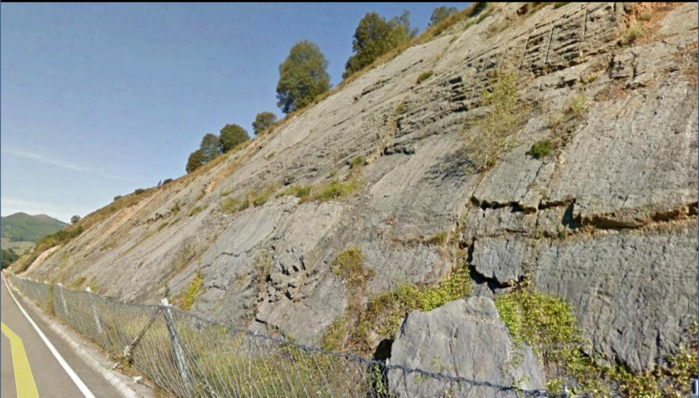
Intento de estabilización de talud. Dolomías/calizas tableadas, del Triásico Sup.-Lias, Jurásico Inf. E de Puentenansa, Cantabria. W Centro Hoja de Cabezón de La Sal.
