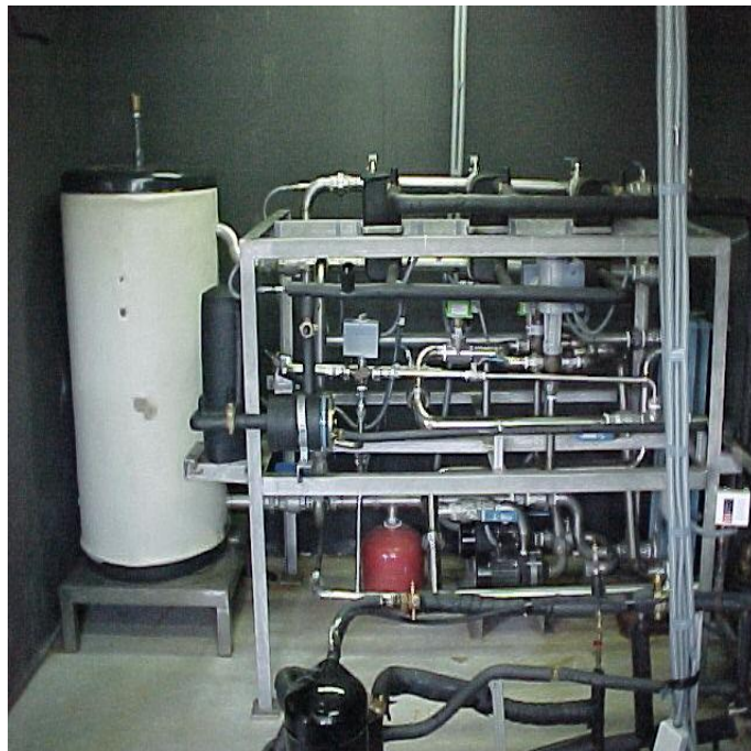
Figura 6.7: Unidad de condensación y circuitos de agua.
