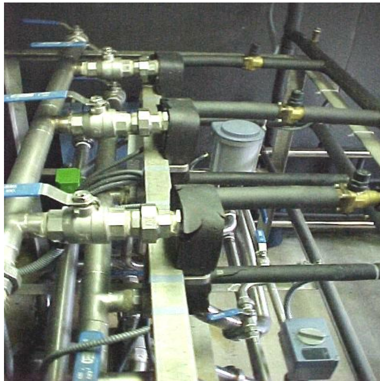
Figura 6.5: Unidad de condensación.
