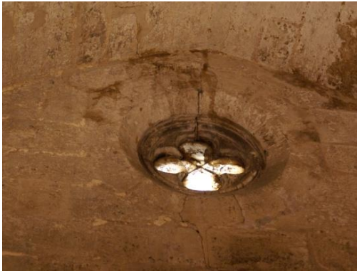
Ilustración 501 – Grieta en pared de la capilla P6
