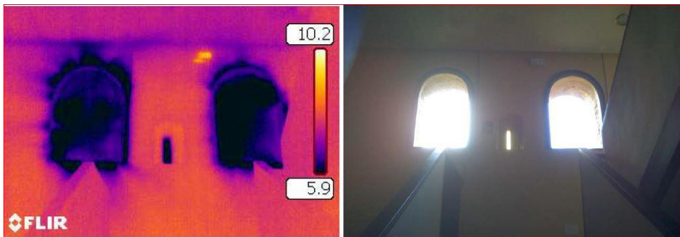
Ilustración 252 – Entrada por filtración de aire en las ventanas del Castillo-Palacio ducal de Cocentaina. (Alicante) (Tormo Esteve & Royo Pastor)
