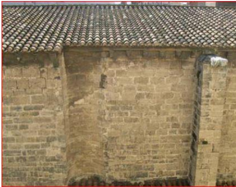
Ilustración 54– Huella de la torre de acceso a la cubierta del S XIII.(Crespo Godino, 2006, pág. 87)
