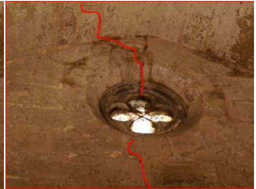
Ilustración 502 – Grieta en ventanal de la capilla P6
