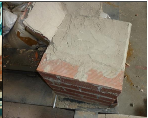
Ilustración 212.- Desplazamiento y giro del machón tras el colapso.
