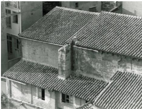
Ilustración 81 – Tramo 6 antes de la rehabilitación (Ferrant Vázquez, 1967)
