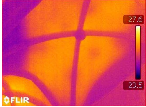
Ilustración 269 – Termografía de la bóveda de la capilla P7.
