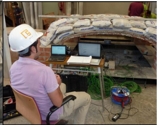
Ilustración 208.- Monitorización de deformaciones
