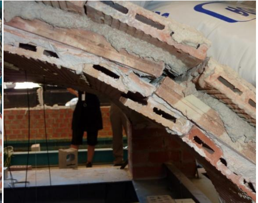
Ilustración 216.- Formación de grieta en uno de los arcos.
