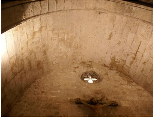
Ilustración 499 – Grieta en pared de la capilla P6
