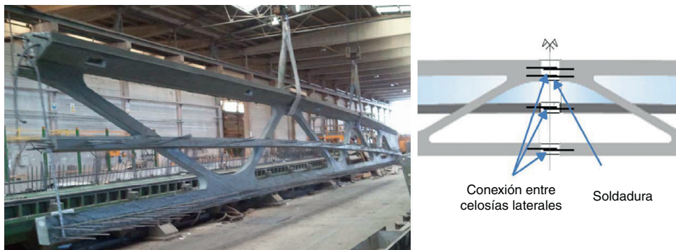
Figura 24. Transporte de una mitad de la celosía lateral (izquierda); conexión de ambas celosías (derecha).
