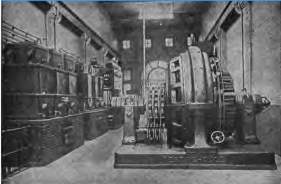
Figura 3.15. Subestación transformadora de corriente alterna a continua de la empresa Brooklyn Edison, Nueva York. Fuente: Hawkins (1917).
