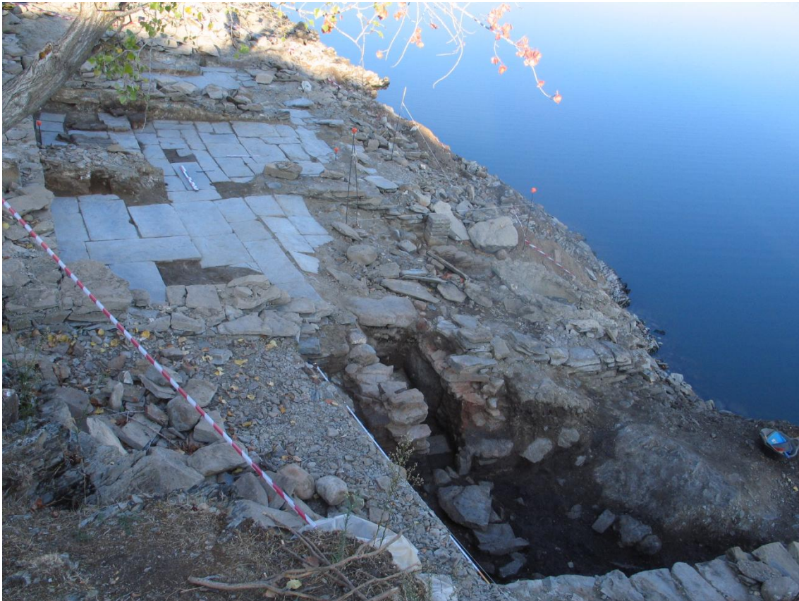
Fig. 43: "Baño de Albalat" en 2009 (fotografía de Sophie Gilotte). El área se presenta bastante afectada, ya que, además de situarse en la zona de oleaje, se encuentra ubicada en una zona de pendiente, con lo que el arrastre es mucho mayor, produciéndose desalojo lateral y el desmoronamiento de bloques enteros.
