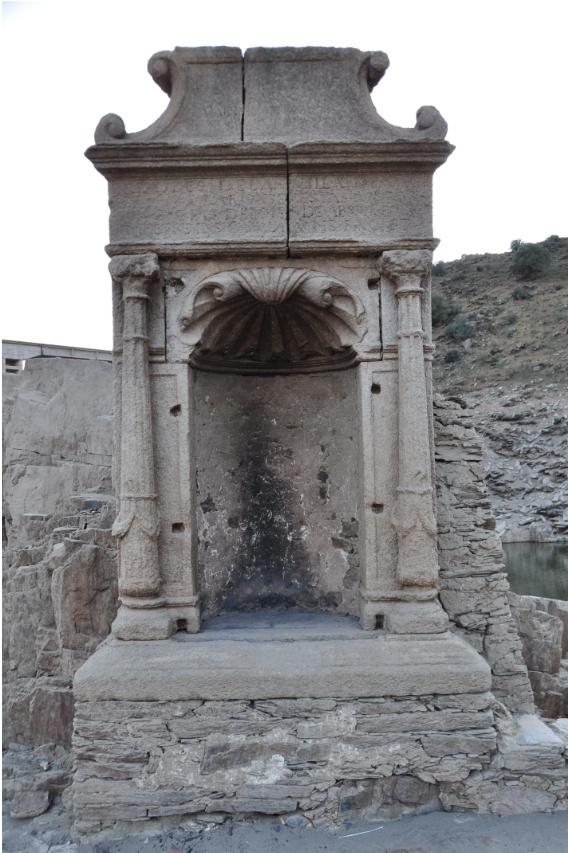
Fig. 39: Hornacina ubicada en medio de los "Puentes de Don Francisco." (Embalse de Alcántara). Durante el período de sequía de 2012, se realizó una hoguera en su interior. También, en la fotografía puede observarse como la "deflación" va afectando a las juntas (esta afección será explicada en los próximas líneas)
