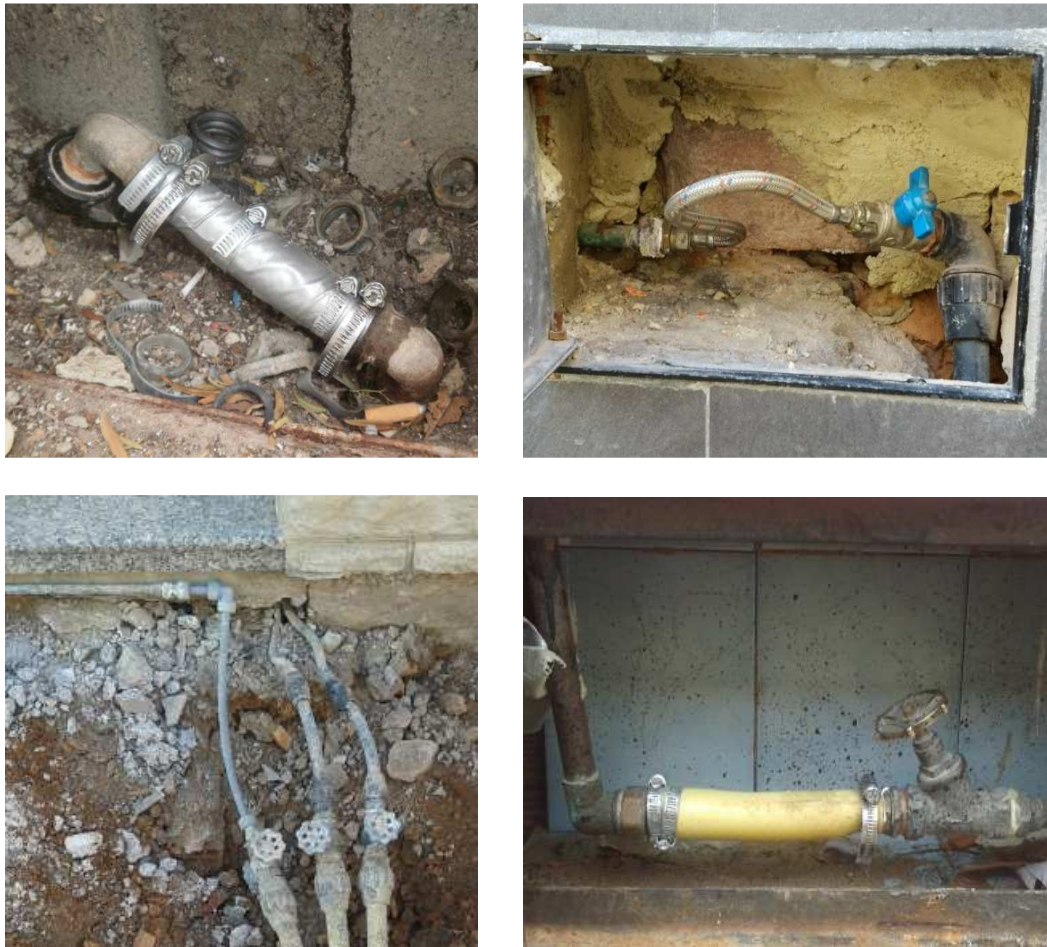
FIGURA 2.2 EJEMPLOS DE CONEXIONES ILEGALES
