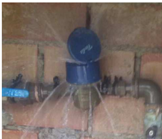
FIGURA 3.20 EJEMPLO DE ROTURA DEL TOTALIZADOR DE UN CONTADOR
