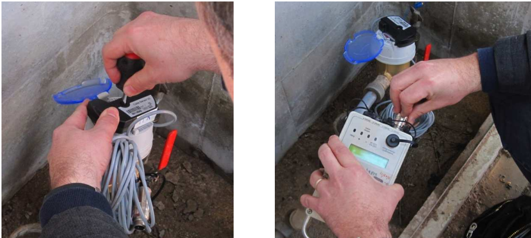
FIGURA 3.4 INSTALACIÓN SOBRE EL CONTADOR DEL EMISOR DE PULSOS Y DATA-LOGGER
