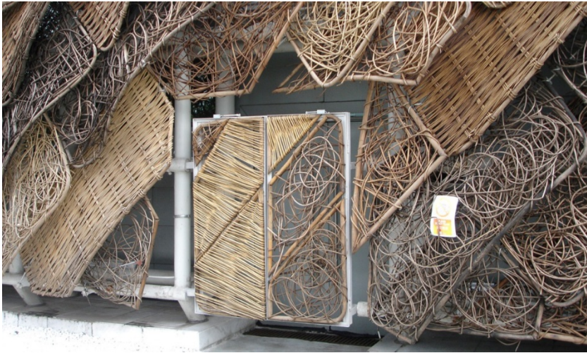
Fig. 65: Paneles adaptados a una zona de acceso. Foto: Elaboración propia (2010)
