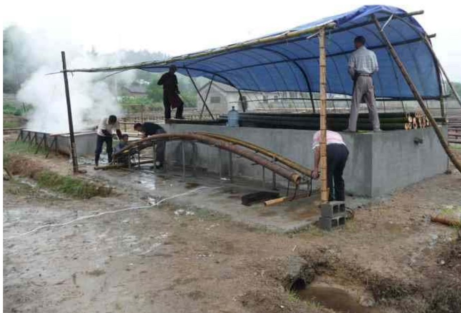
Fig. 145. Tratamiento inicial del bambú para la construcción del pabellón. Fuente: Press Material
