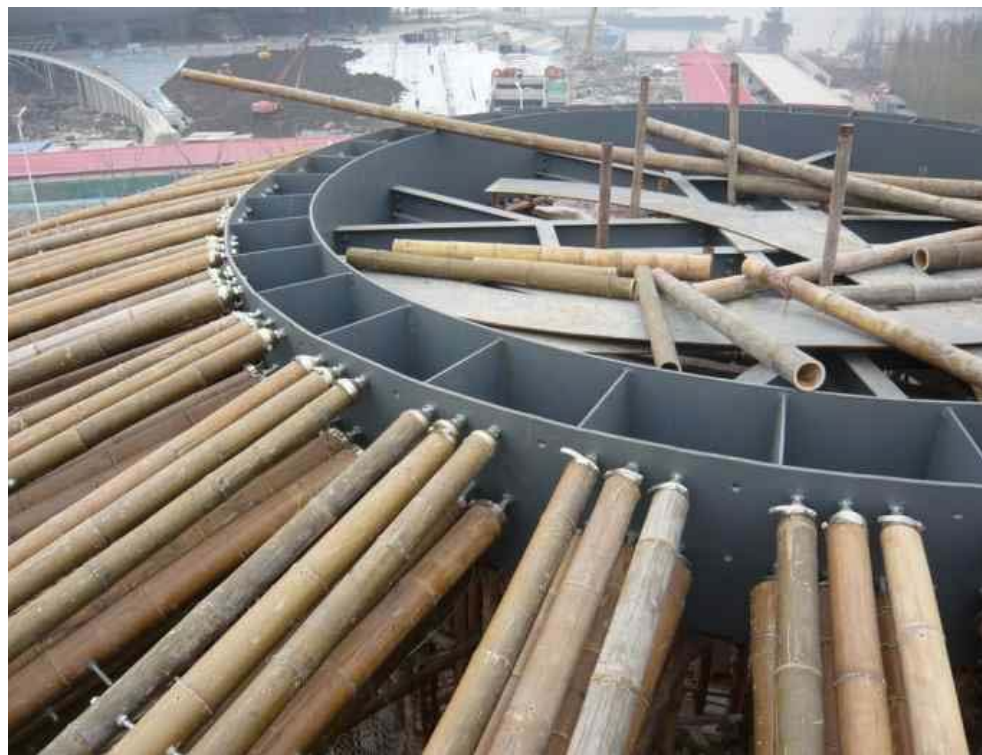
Fig. 150: Cúpula: Anclaje de las vigas de bambú al anillo de acero superior. Fuente: Press Material.
