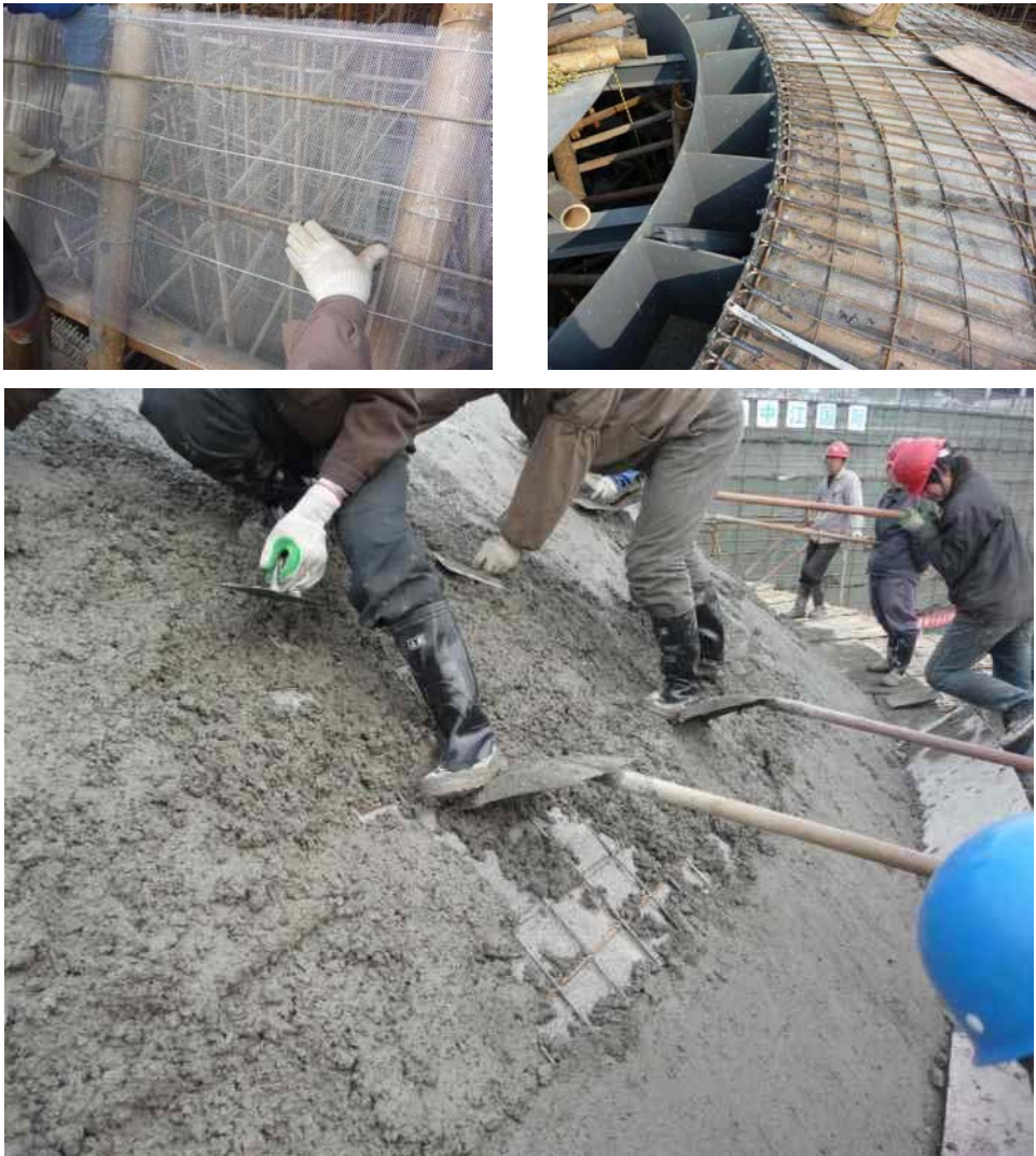
Fig. 152: Colocación de la malla metálica y cubrimiento de microhormigón en la cúpula. Fuente: Press Material.
