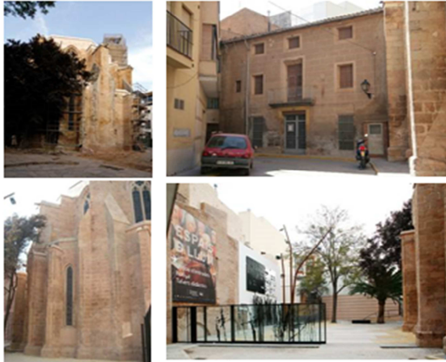
Ilustración 7: La demolición del edificio de la casa parroquial permitió la apertura de una plaza y la recuperación del ábside gótico de la iglesia al que estaba adherido.
