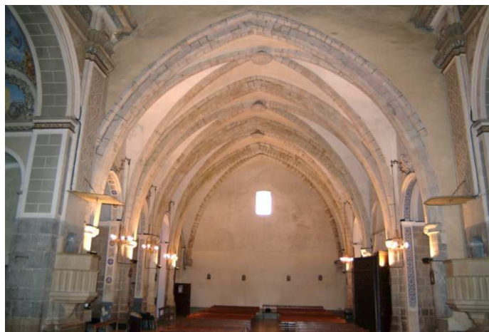
Ilustración 47: Estado de la iglesia de Nuestra Señora del Socorro antes de su restauración.
