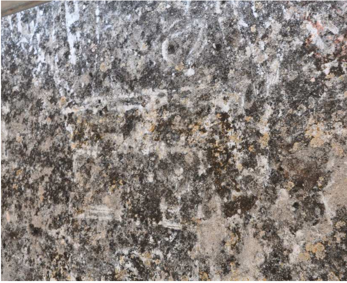
Ilustración 69: Detalle de hongos y líquenes adheridos a la fachada
