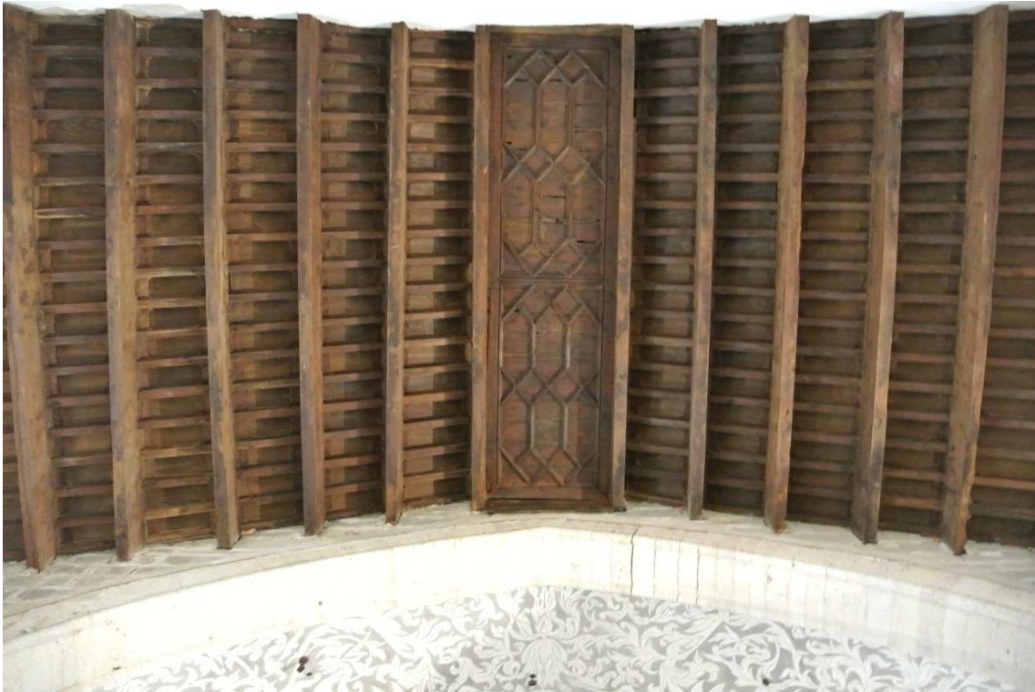
Ilustración 74: Estado final de la restauración, desde el interior, de la estructura de la sexta crujía que era la que presentaba un mejor grado de conservación.
