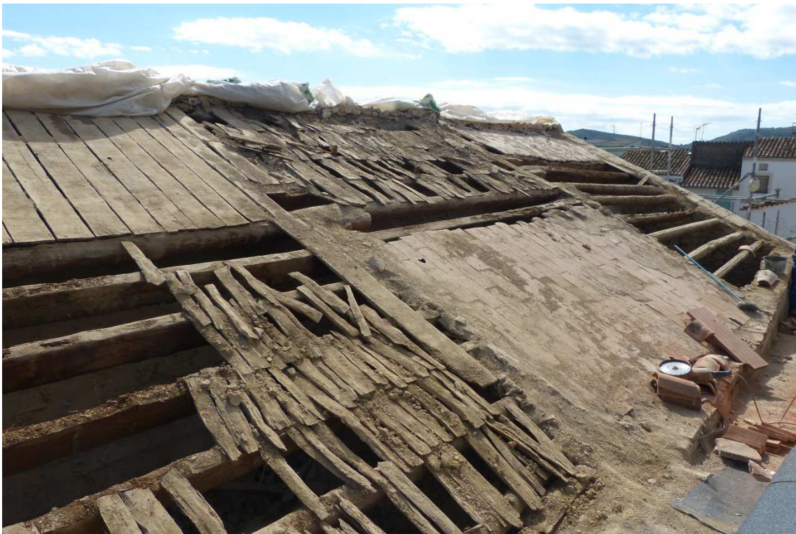
Ilustración 72: Estado de conservación de la estructura de madera de la cubierta original.
