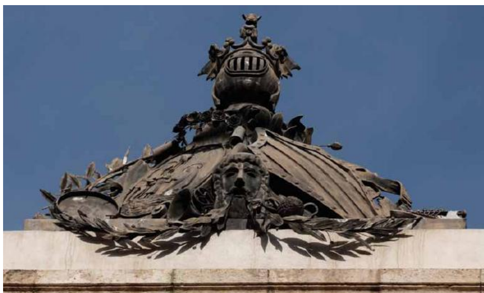
Figura 35 (Superior) - Fachada recayente a la calle de las Barcas. Acceso principal al teatro Figura 36 (Inferior) - Remate de coronación de la fachada principal del teatro
