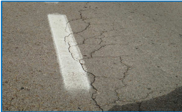
Imagen 2 – Ejemplo de deterioro en el firme de la travesía
