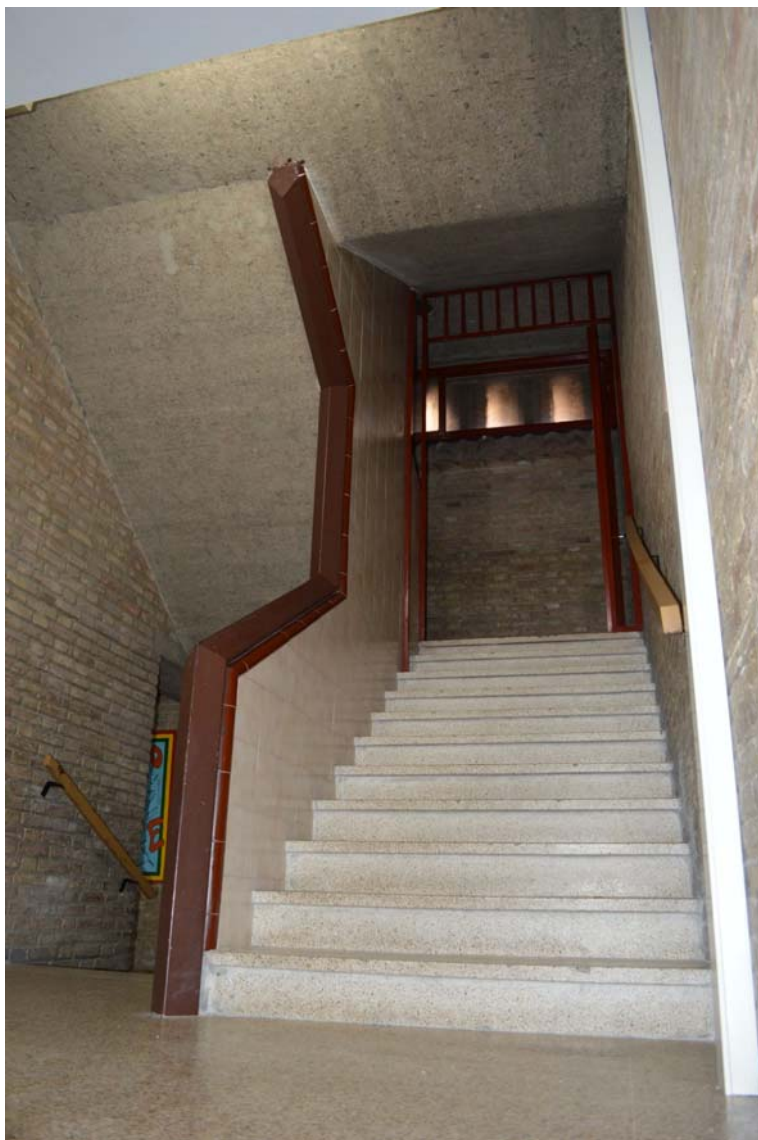
[51] V15: Planta primera. Tramo de escalera, revestida en el murete vertical, de placas cerámicas vitrificadas. Nivel estructural +3,57 m. (2014). Autor: JMMN. V15.I.70.
