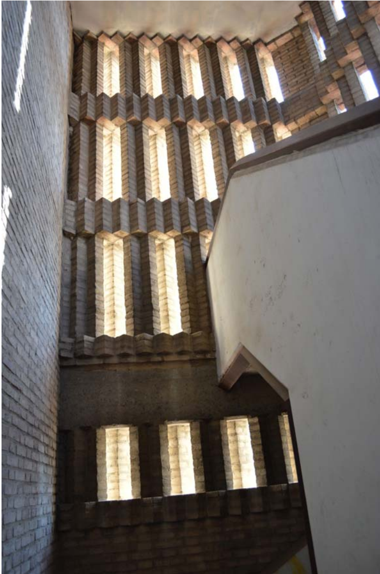
[56] V15: Descansillo entre las plantas, sexta y séptima. Celosía de ladrillo en campanario y culminación del desarrollo de la escalera. Nivel estructural +20,74 m. (2014). Autor: JMMN. V15.I.80.
