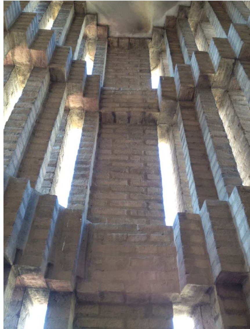
[59] V15: Descansillo entre las plantas, sexta y séptima. Esquina de la celosía de ladrillo en campanario, colindante con la calle E. José Capuz. Nivel estructural +20,74 m. (2014). Autor: JMMN. V15.I.83.
