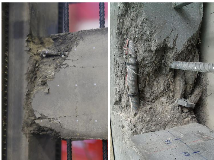
Figura VII.4. Pandeo local de las armaduras longitudinales
