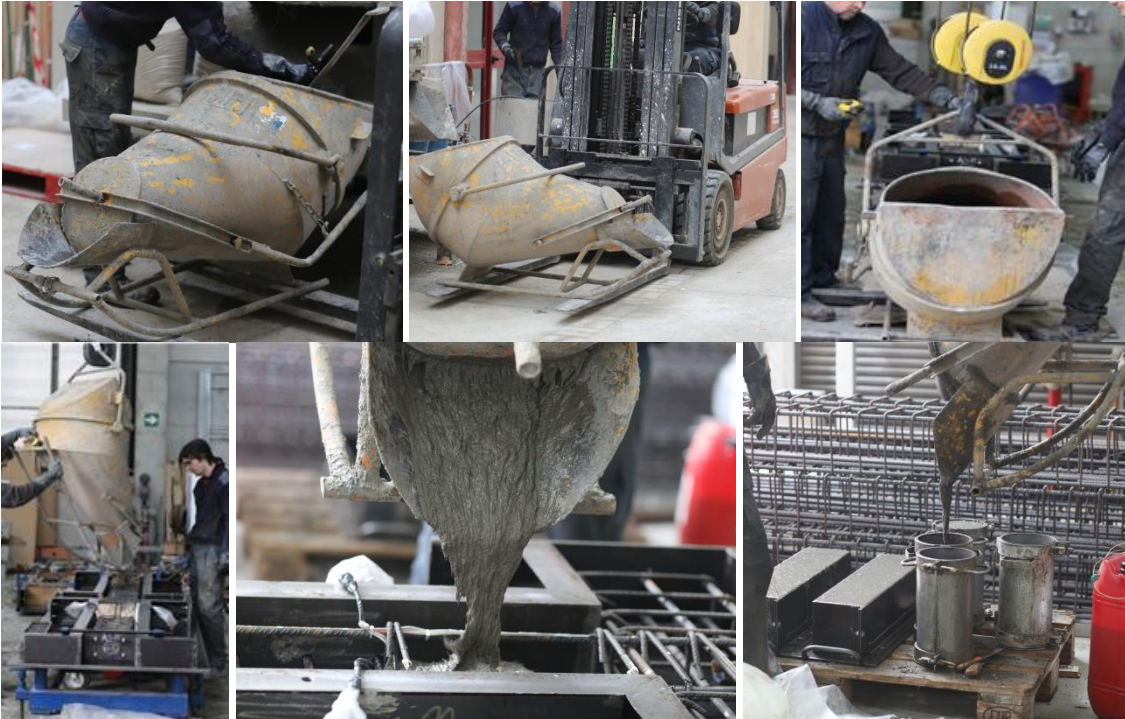
Figura V.31. Vistas de las fases de transporte y vertido del hormigón en la pieza principal y probetas de control
