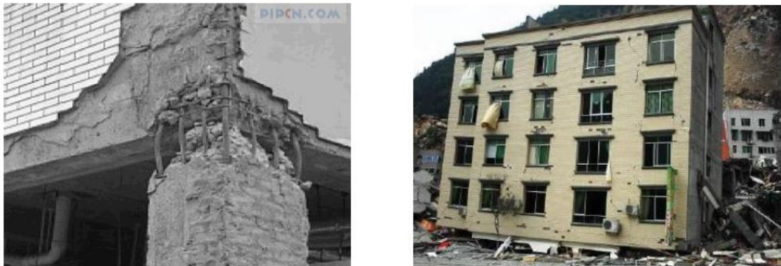
Figura II.1 Terremoto en Wenchuan (China) en el año 2008. Rótula plástica en soporte. Edificio colapsado en su base. Cai et al. (2012) [29]
