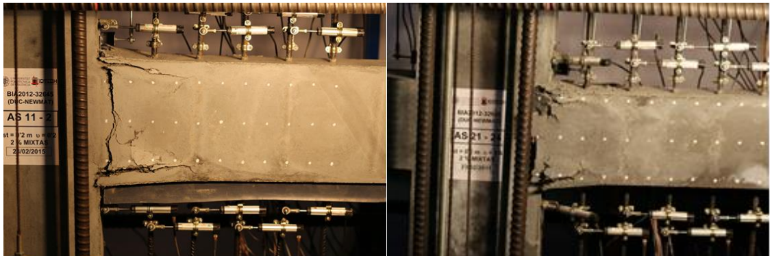
Figura VII.10. Rotura de soporte AS11-2R y AS21-24
