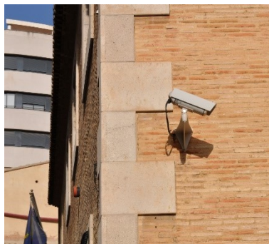
Fuente 63. Autor: AP&ER. Cámaras de Seguridad en el Centro Histórico Protegido, Calle del Hospital. Barrio de Velluters.
