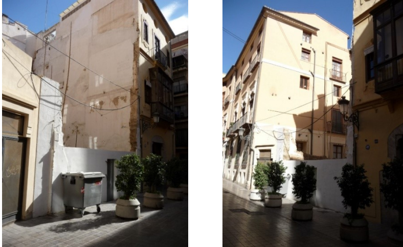
Fuente 17. Autor: Inspección de Patrimonio. Dirección Territorial de Cultura-Calle Samaniego, Barrio de la Seu-Xerea Valencia. Edificaciones fuera de ordenación y edificación obsoleta junto a edificaciones catalogadas
