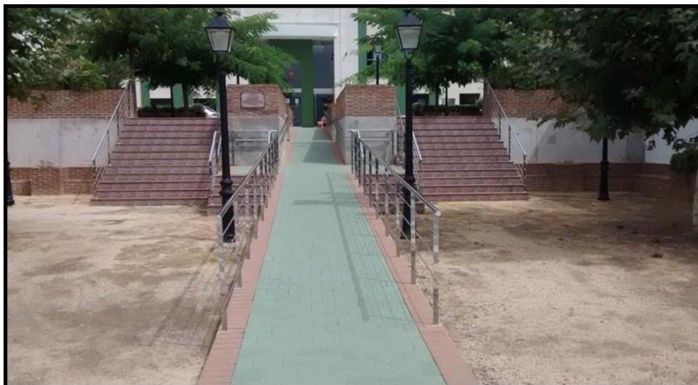
Imagen 5.290. Rampa que acompaña a la escalera con pendiente del 10 % y ausencia de pasamanos a segunda altura. Fuente imagen propia.
