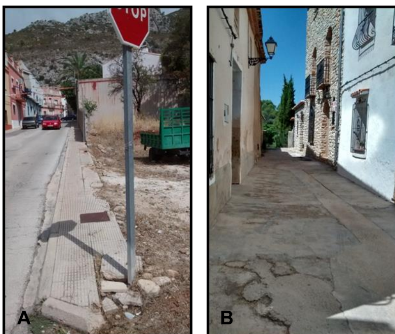
Imagen 5.16. Pavimento deteriorado en Benimeli (imagen A) y en La Carroja (imagen B). Fuente: imagen propia.
