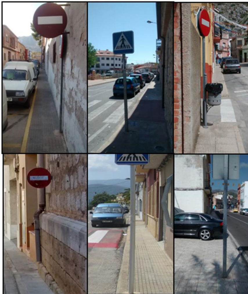
Imagen 5.324. Inadecuada ubicación de señales. Señales ubicadas en el borde exterior de la acera siendo el ancho libre de paso inferior a 1,5 metros y otras adosadas a fachada a una altura inferior a 3 metros. Fuente: imagen propia.
