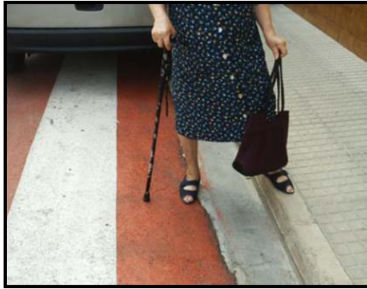
Imagen 5.22. Paso de peatones sobreelevado no enrasado con el bordillo en Sanet i Negrals. Fuente: imagen propia.
