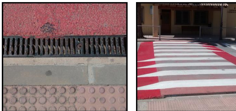
Imagen 5.23. Paso de peatones sobreelevado perfectamente enrasado con la calzada y luz de las rejillas del sumidero de 1cm. Fuente: imagen propia.
