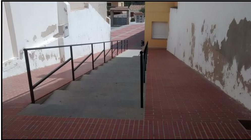
Imagen 5.289. Rampas que acompañan a la escalera con pendientes del 12 %, pavimento deslizante en mojado y ausencia de pasamanos a ambos lados. Fuente imagen propia.
