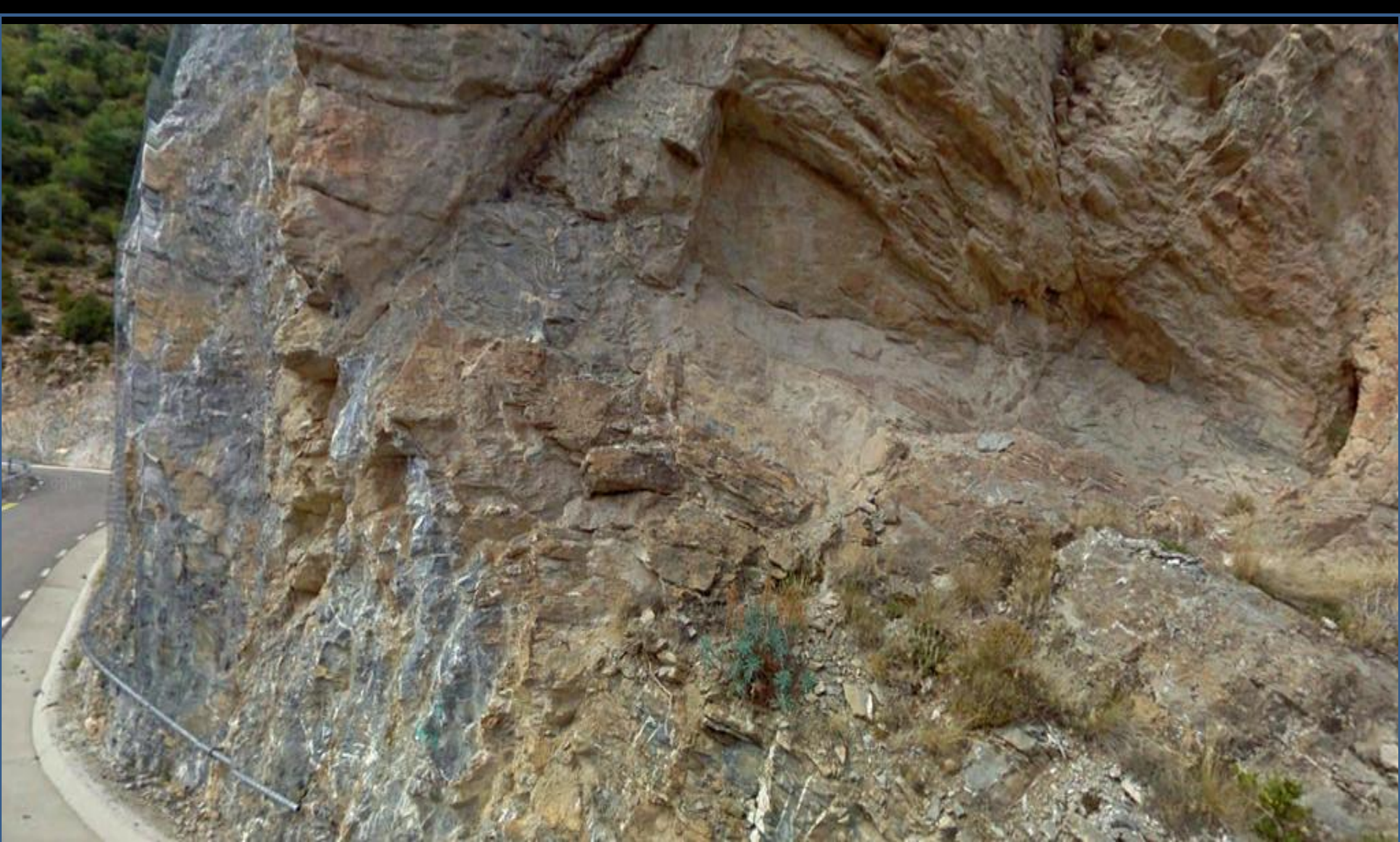
Mallazo en parte de talud de calizas del Devónico. SW de Trejubell, Lérida. Centro N Hoja de Orgañá.
