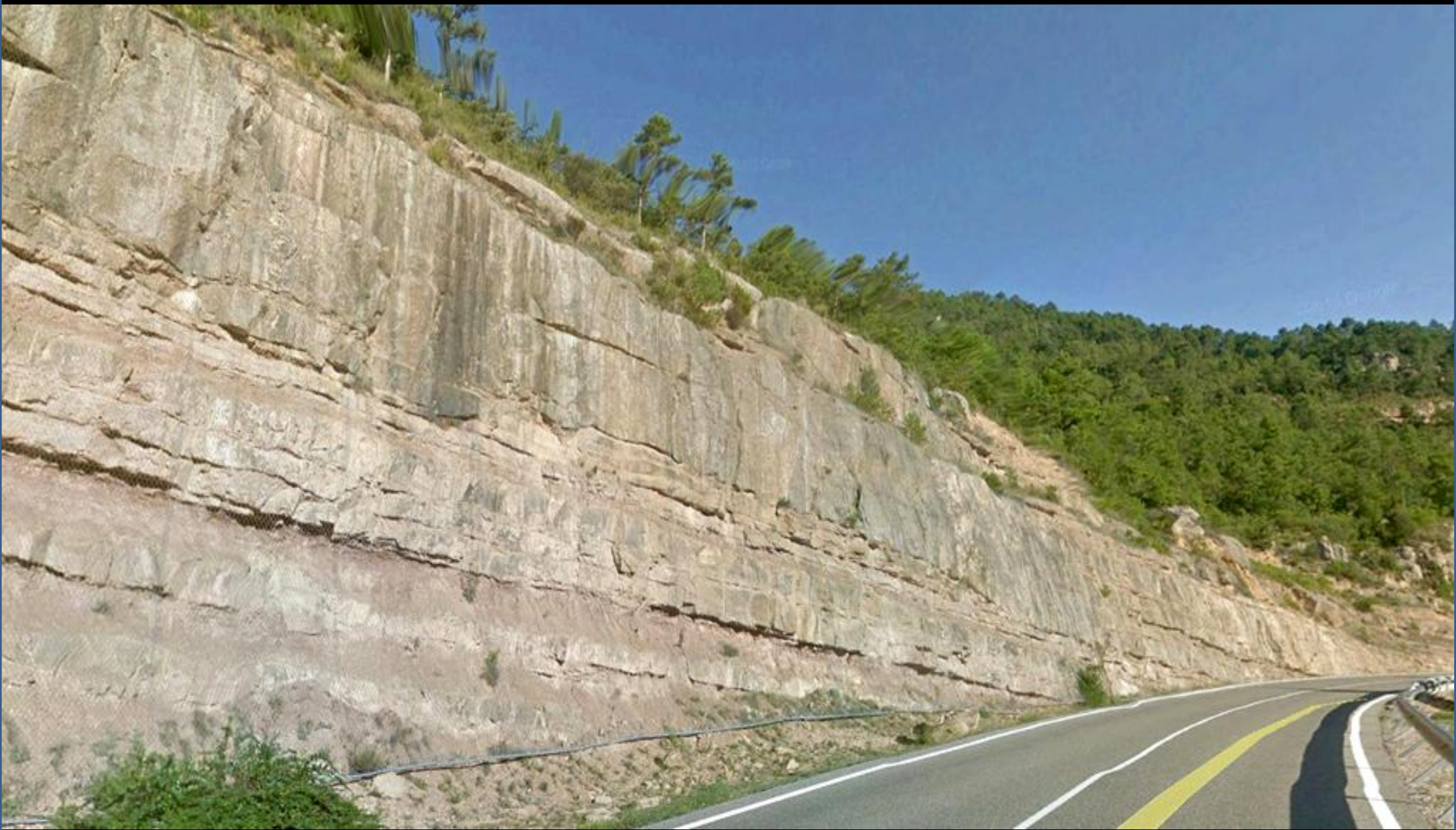
Talud de areniscas y arcillas del Paleógeno, Terciario, con mallazo. S de San Andreu del Cavall, Lérida. SE Hoja de San Lorenzo de Moruny.
