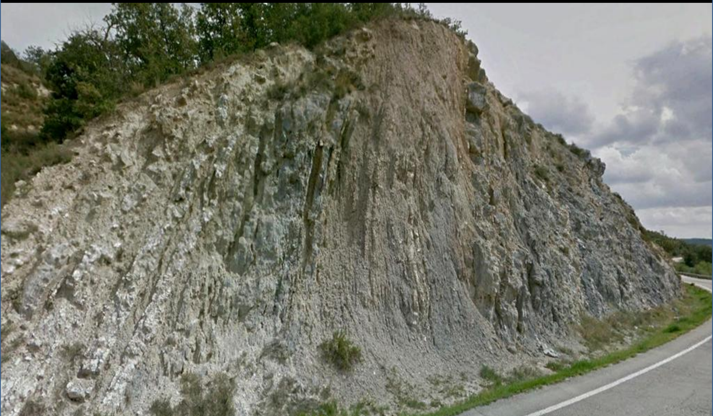
Yesos y margas grises del Priaboniense, Eoceno, Terciario. SE de Pons, Lérida. SW Hoja.
