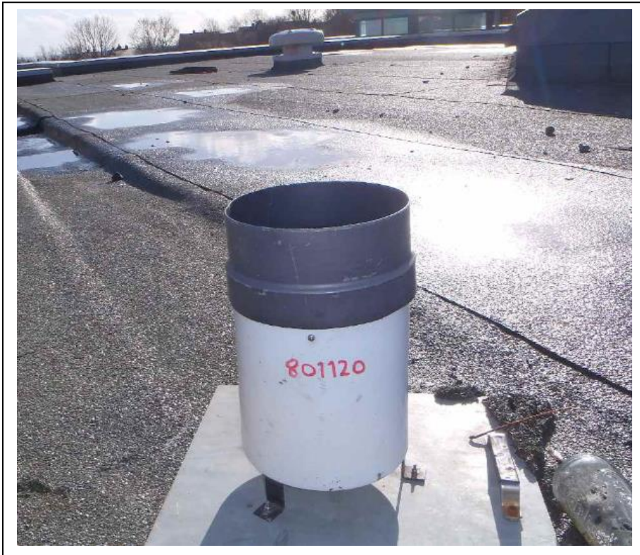
Figura 5.1.09.- Ejemplo de instalación de un pluviógrafo
