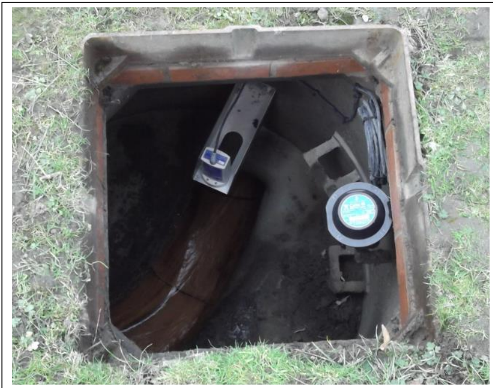
Figura 3.1.6.- Ejemplo de estación de telemetría
