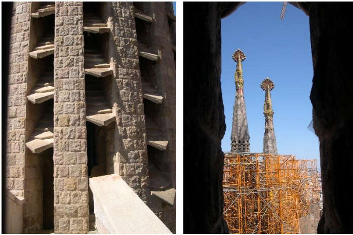
Detalle de los tornavoces de un campanario. Formas, signos, inscripciones en el remate de los campanarios. Fuente: fotografías del autor.
