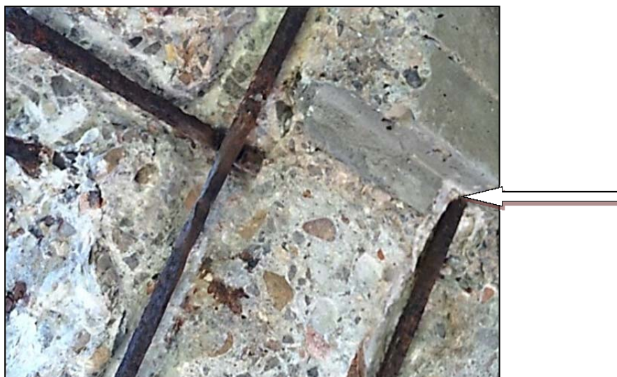
Fig. 4.16. Falta de recubrimiento de una armadura en una viga en un edificio de la localidad de Benicàssim
