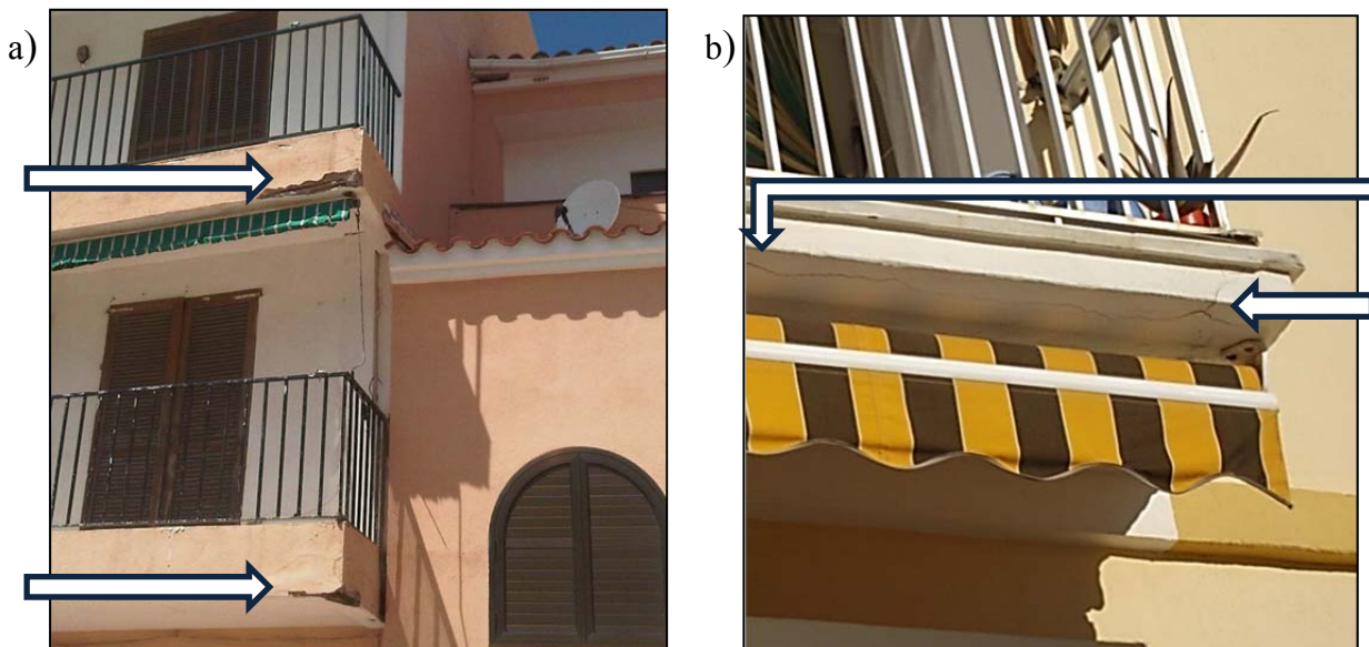
Fig. 5.7. Lesiones en los frentes de forjado en terrazas: a) desprendimientos y b) grietas
