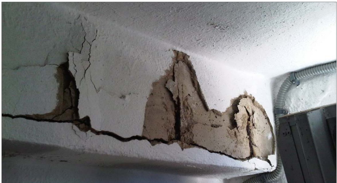
Fig. 7.13. Desprendimiento del recubrimiento en viga
