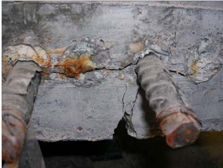
Fig. 2.25. Fisuración del recubrimiento (Moreno 2008)
