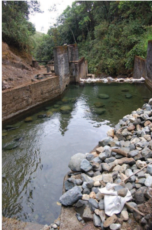
Figura 16. Infraestructura de la captación de El Guando.
