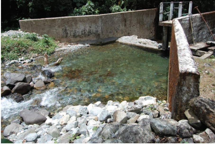
Figura 17. Infraestructura de la captación del Mirmir.
