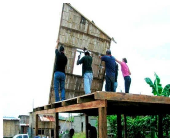
Figura 4. Colocación de paneles prefabricados de "caña picada" usados como cerramiento en los palafitos
