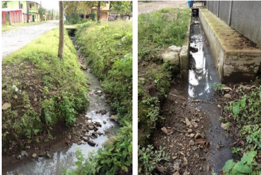
Figura 8. Cunetas utilizadas para drenaje sanitario y pluvial. (Iraheta O., Torres M., & Gonzales P., 2015)
