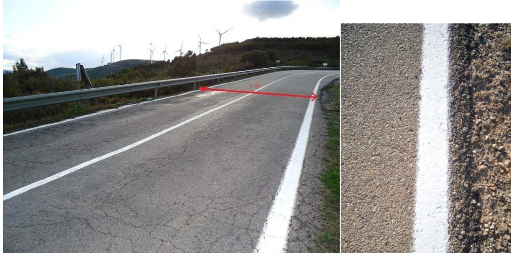
Figuras 70 y 71. Estrechez de la calzada y falta de arcén.
