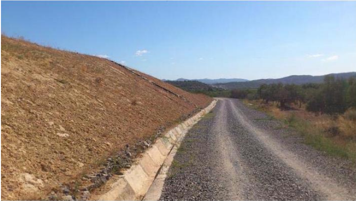
Figura 9. Canal de recogida de pluviales.
