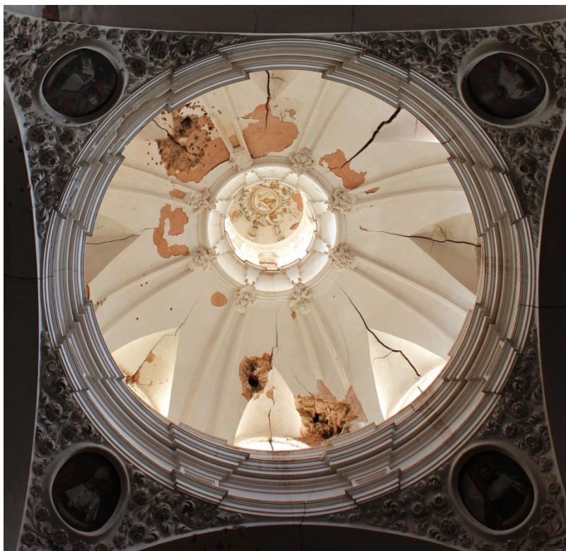
Fig. 10. Lamentable estado de conservación de la cúpula.
