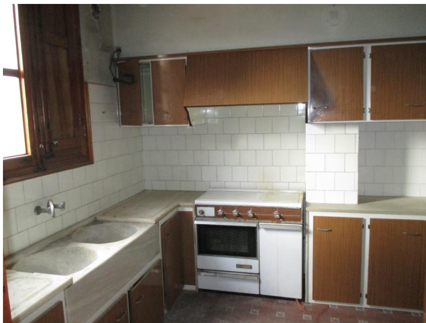
Figura 17. Mobiliario de la Cocina 2016, Fuente Propia
