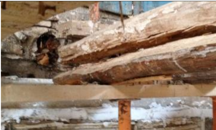
Viguetas partidas por pudrición
