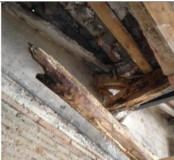
Viga partida por disminución de sección, y falta de vigueta quedando el material de cobertura a la vista
