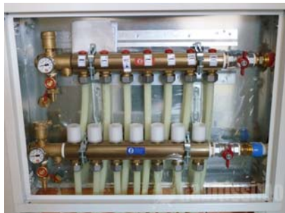
colector de distribución suelo radiante.
