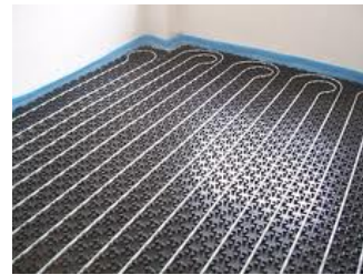
conductos suelo radiante.
