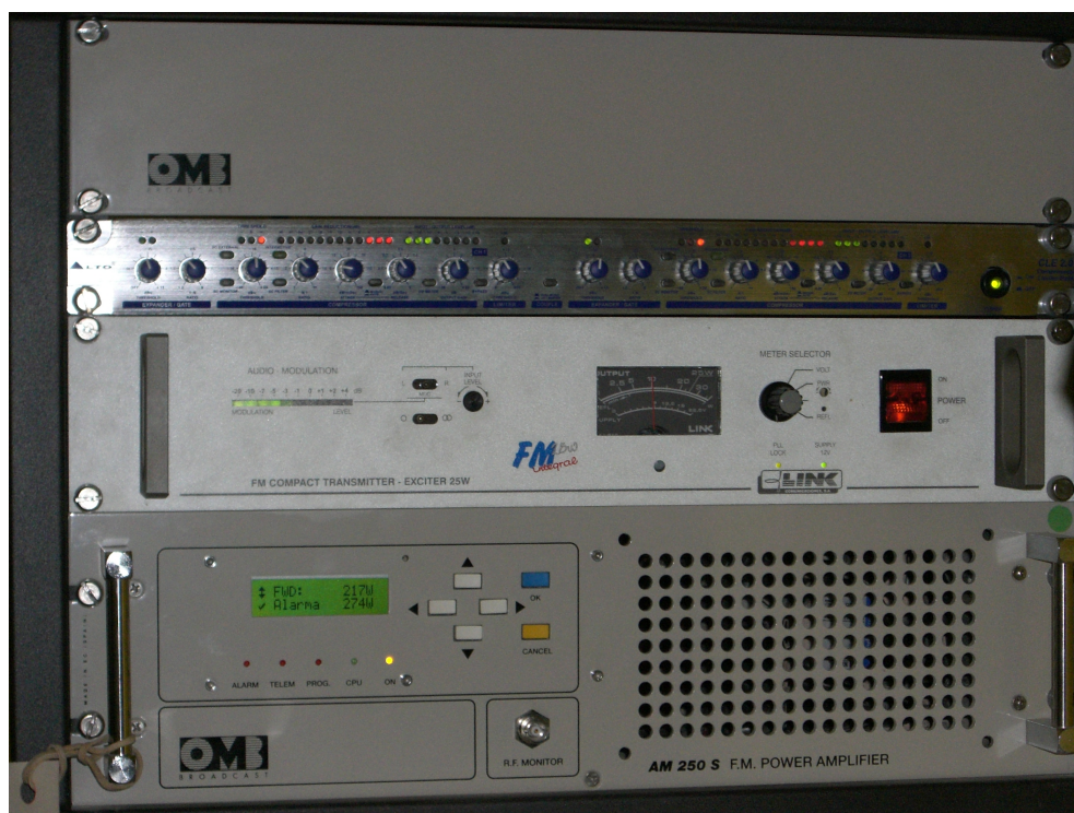
Figura 33. Imagen de los equipos de alta frecuencia situados en el Archivo, julio de 2014.
