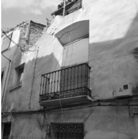
Figura 6: Abombamiento parte central del muro y derrumbamiento parte superior
