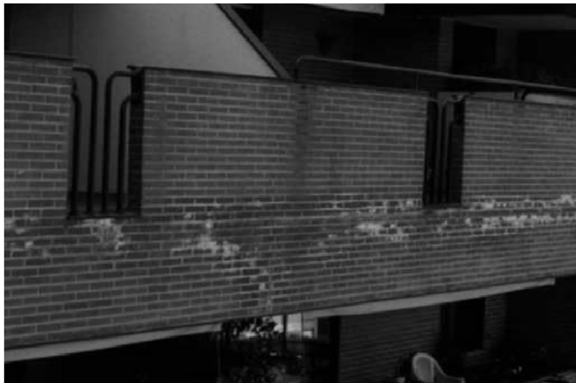
Figura 1. Lesiones químicas: eflorescencias.
