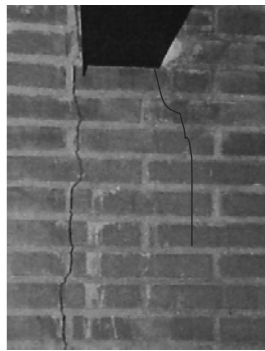
Figura 4: Grieta por cargas puntuales
