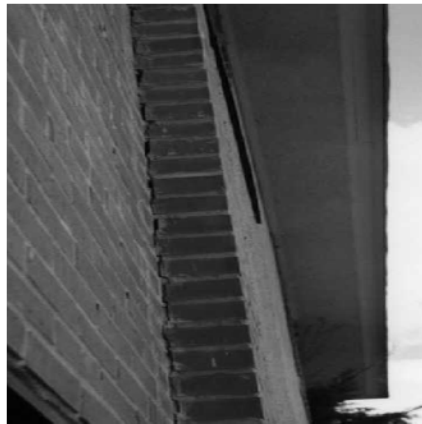
Figura 8. Conexión inadecuada entre tramos de un mismo muro
