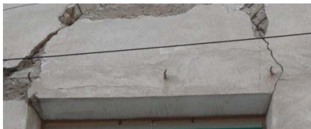
Figura 9. Grietas sobre los huecos
