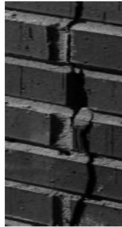
Figura 3: Grieta vertical por agotamiento a compresión
