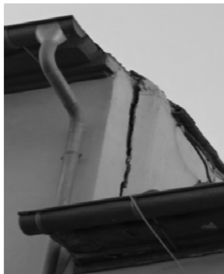
Figura 5: Grietas producidas por desplome del muro
