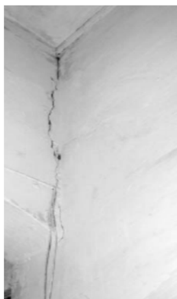
Figura 7: Grieta vertical entre dos muros sometidos a diferentes cargas verticales
