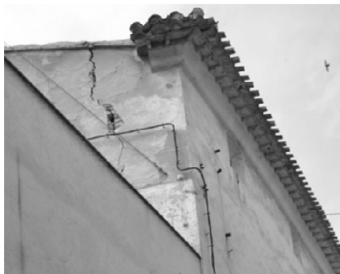
Figura 12. Lesiones en muro de fábrica
