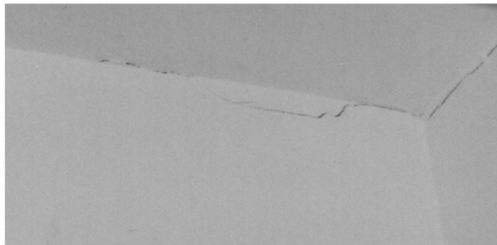
Figura 6. Grieta en partición interior.
