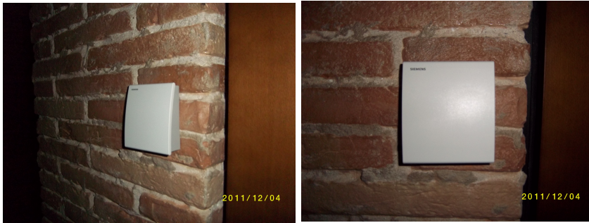
Figura 38. Sondas Siemens-Symaro instaladas en el Museo de Historia de Valencia (Fuente: Elaboración propia).
