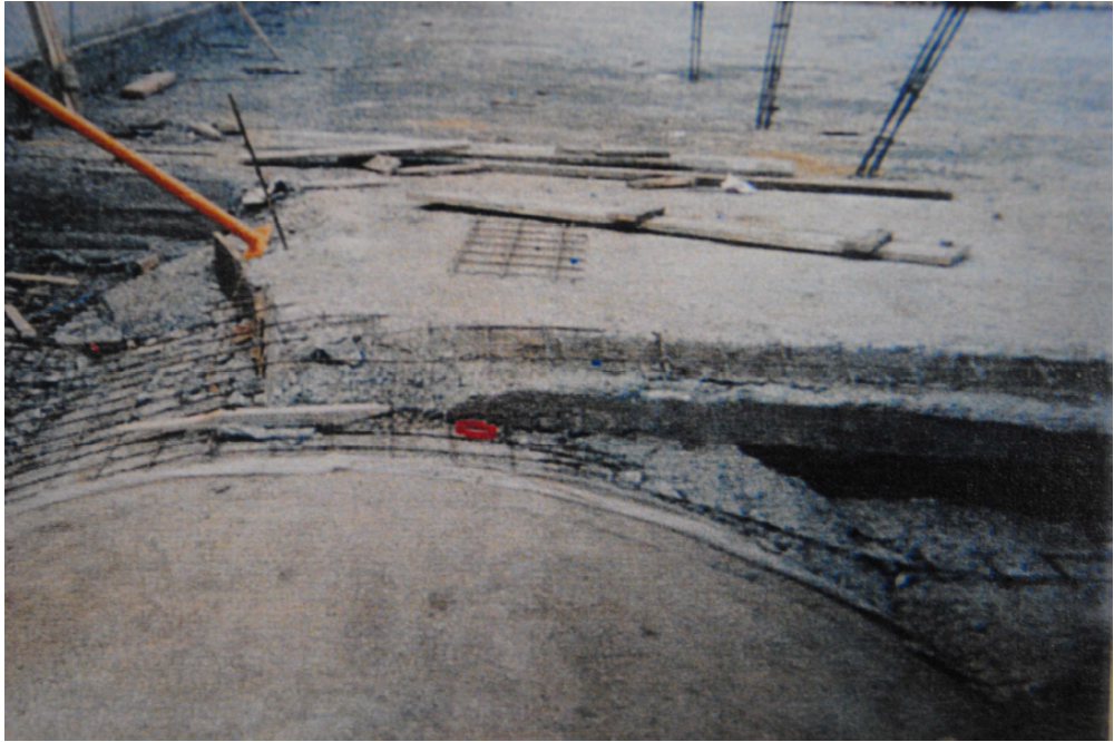
Figura 15. Construcción de la cubierta plana del Museo de Historia de Valencia (Fuente: MHV).
