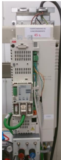
Figura 4.14 Variador de frecuencia marca ABB modelo ACSM1-04AS-024A-4+L516.
