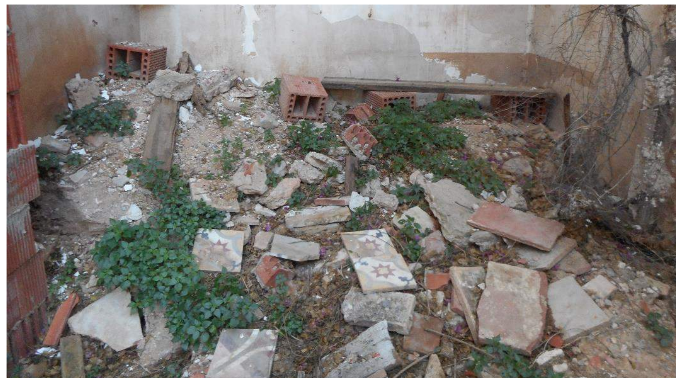
Ilustración 66. Escombros de pavimento, 2016. Fuente: Propio autor
