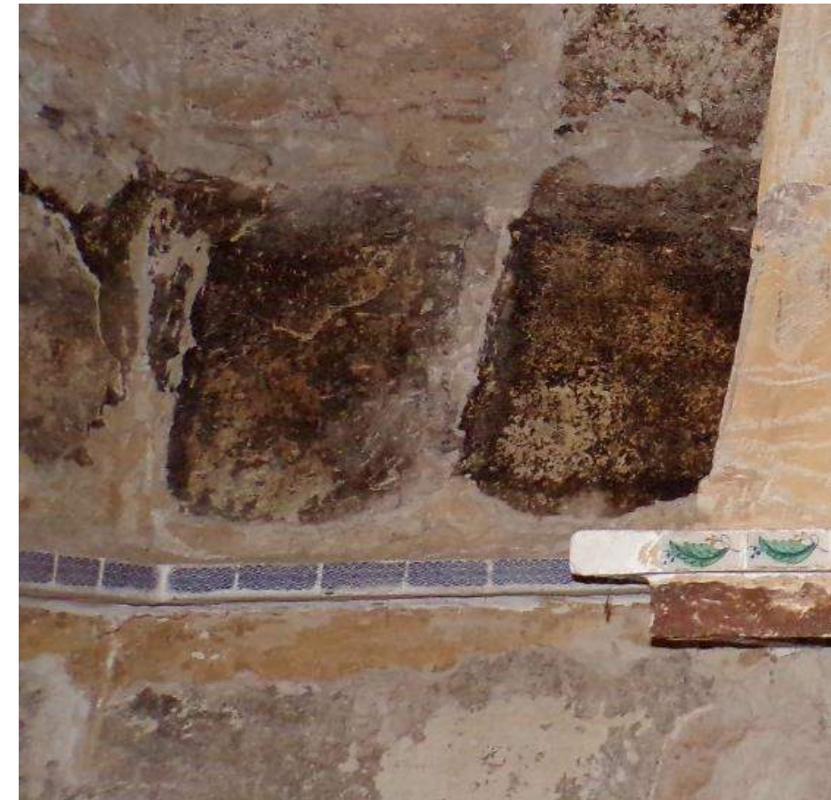
Ilustración 57. Mancha de suciedad en la cocina de la sala 1CC, 2016. Fuente: Propio autor
