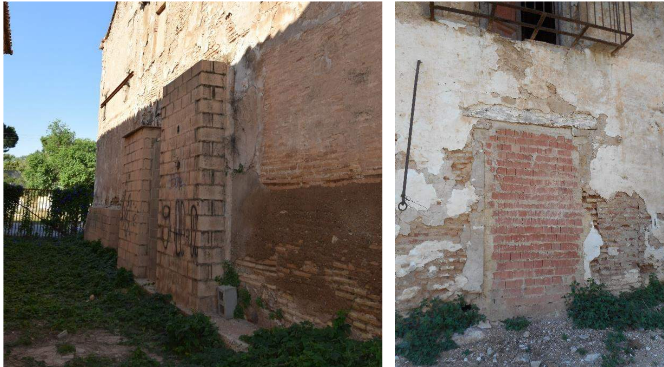
Ilustración 62. Elementos impropios de la fachada este y norte, 2016. Fuente: Ana María Montero Mondría
