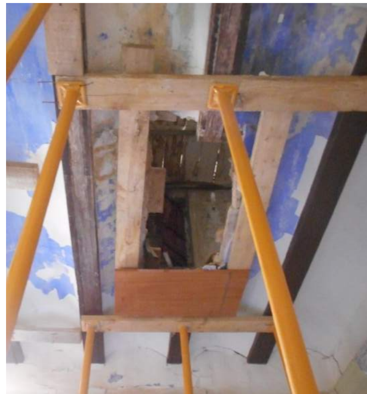
Ilustración 36. Caída del forjado y revestimiento, 2016. Fuente: Propio autor
