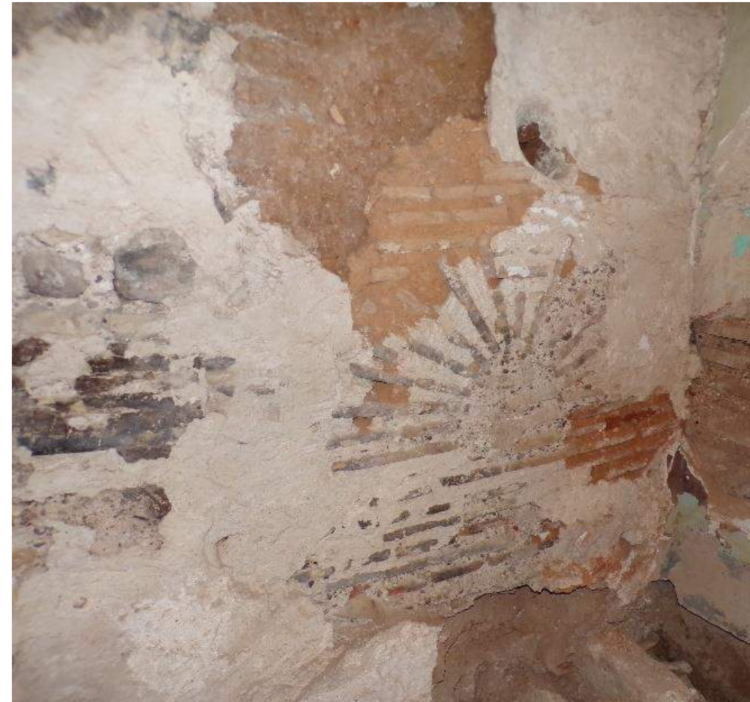
Ilustración 63. Caída del revestimiento de la sala 1AC, 2016. Fuente: Propio autor
