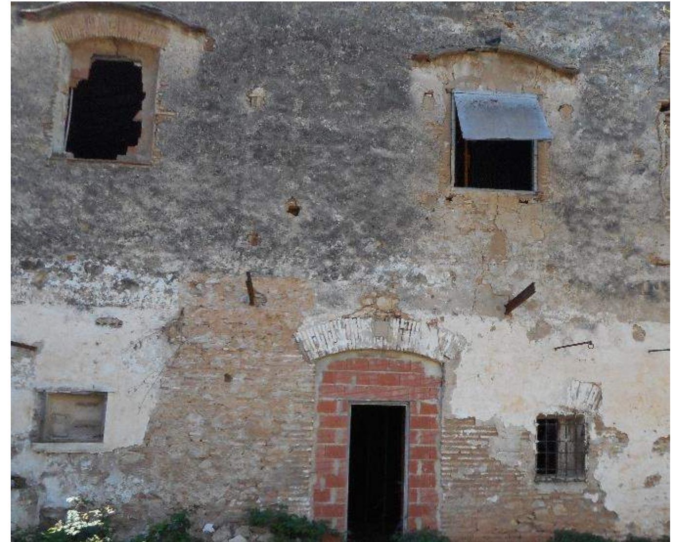
Ilustración 61. Carbonatación del mortero de cal de la fachada norte, 2016. Fuente: Propio autor
