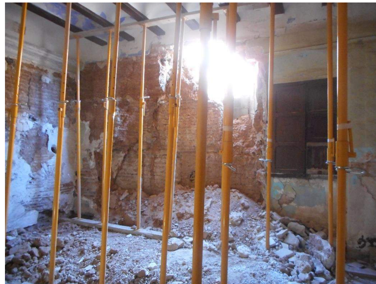
Ilustración 30. Derrumbe parcial del paramento de la estancia 1AB, 2016. Fuente: Propio Autor
