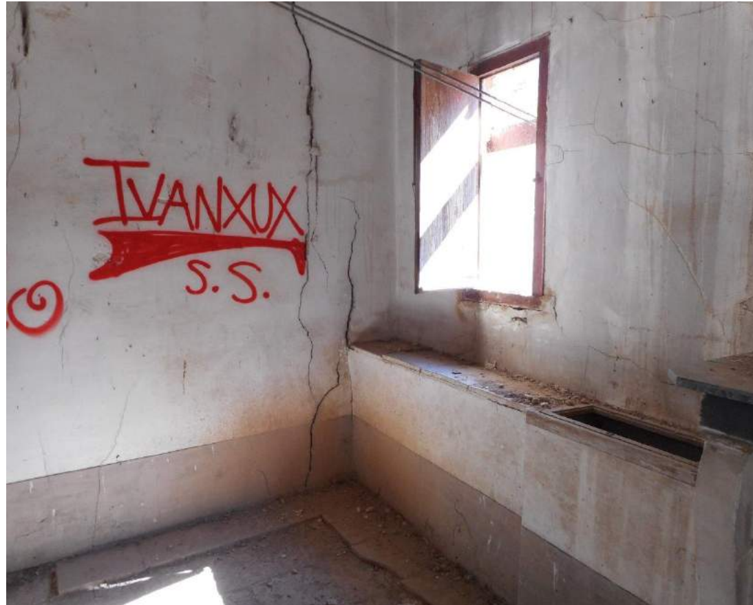
Ilustración 39. Fisura y grafiti en la sala 2DA, 2016. Fuente: Propio autor
