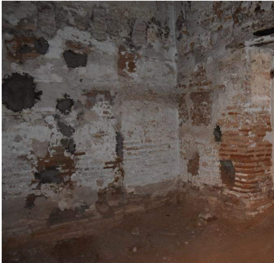
Ilustración 58. Humedad en la sala 1AA, 2016. Fuente: Propio autor
