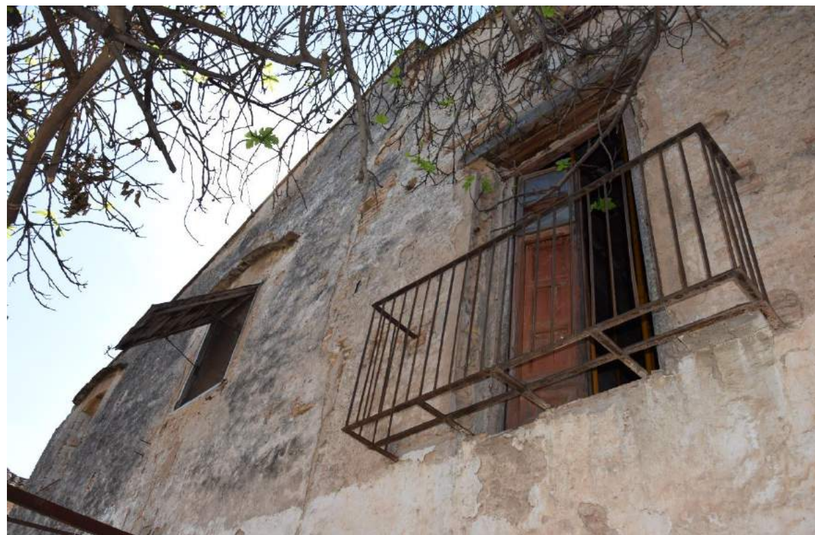
Ilustración 40. Falta pavimento forjado, 2016. Fuente: Propio Autor
