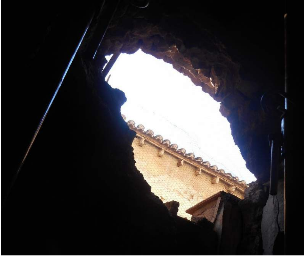
Ilustración 35. Caída del muro de la sala 1AC, 2016. Fuente: Propio autor
