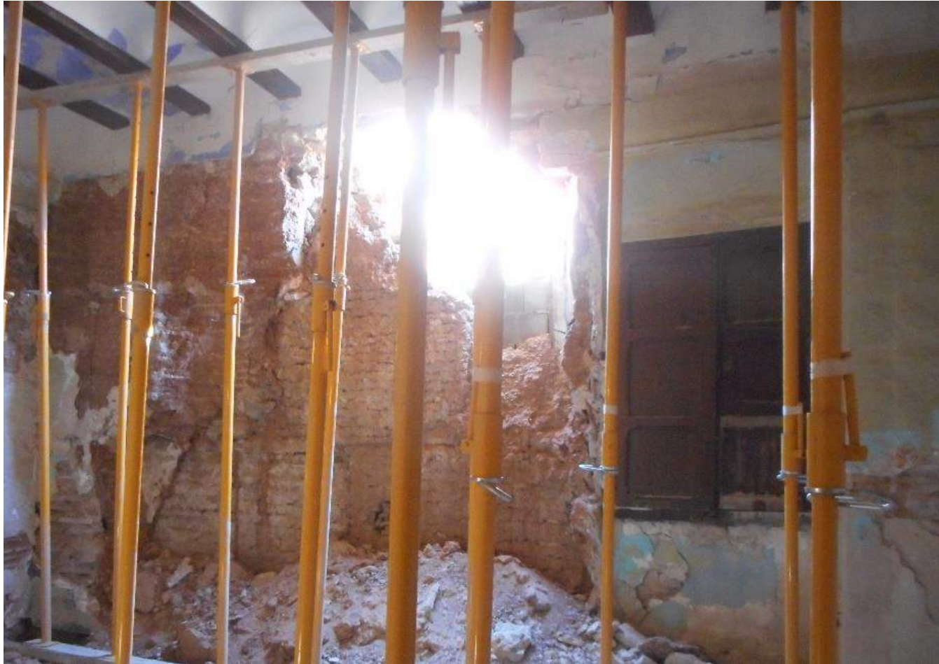
Ilustración 60. Muro derrumbado en la sala 1AC, 2016. Fuente: Propio autor
