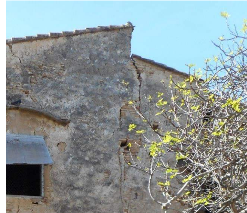
Ilustración 59. Fisura visible en la zona superior de la fachada norte, 2016. Fuente: Propio autor
