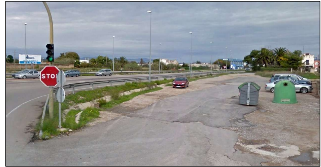
Figura 3.38 – Nulos espacios peatonales y firmes en un estado muy deficiente en las actuales vías de servicio. Fuente: elaboración propia.
