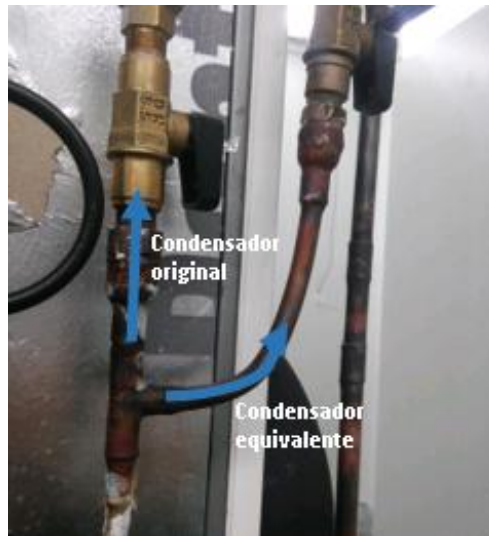
Figura 5.2 Bypass para condensador Refrigerante-agua.
