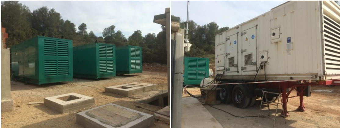
Fig. 17 A la izquierda, grupos electrógenos principales; A la derecha, grupo electrógeno auxiliar. Fuente propia
