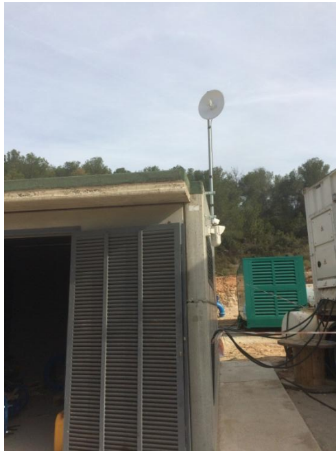
Fig. 60 Antena de red en Tizón 2. Fuente propia
