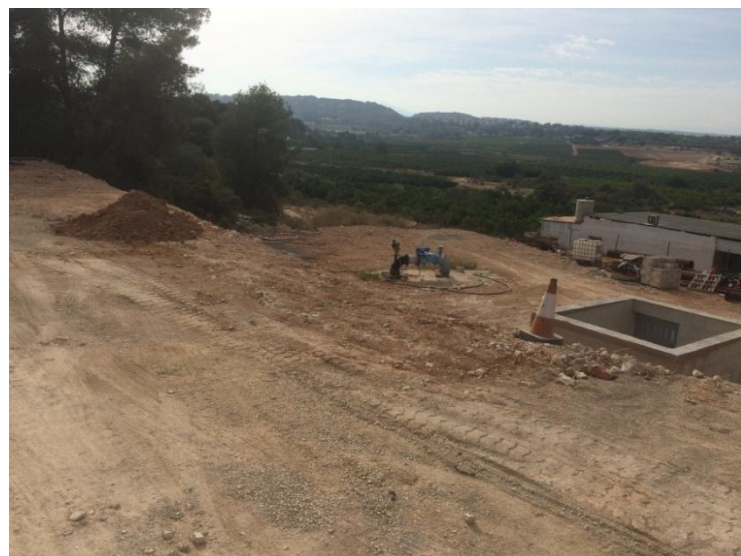
Fig. 56 Acondicionamiento del suelo para la construcción de las instalaciones. Al fondo se ve Tizón 3. Fuente propia.
