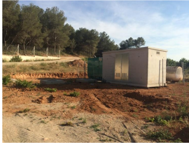
Fig. 21 A la izquierda, los dos grupos electrógenos; A la derecha, entrada de agua al depósito. Fuente propia
