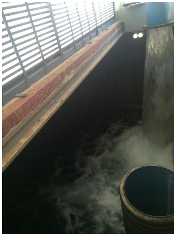
Fig. 22 Entrada del agua procedente de los pozos. Fuente propia
