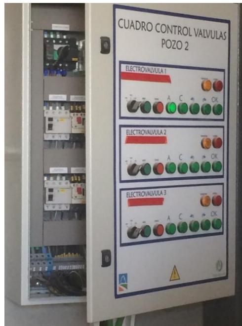
Fig. 58 Cuadro de control de válvulas. Fuente propia
