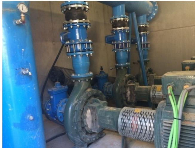
Fig. 23 Las tres bombas conectadas en paralelo. Fuente propia
