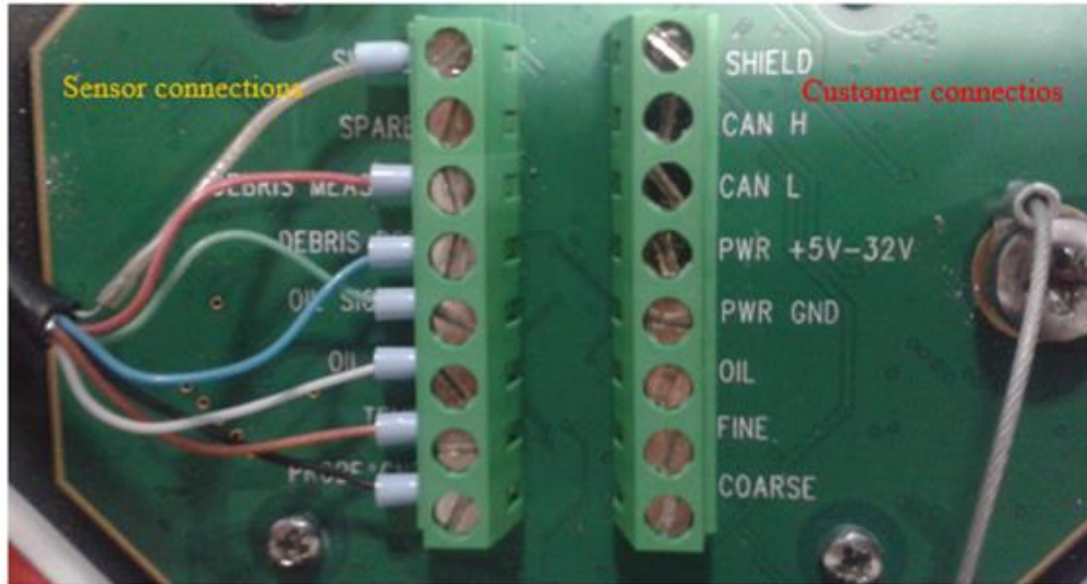
Figura. 20. Puertos de entrada y salida del módulo de control electrónico.
